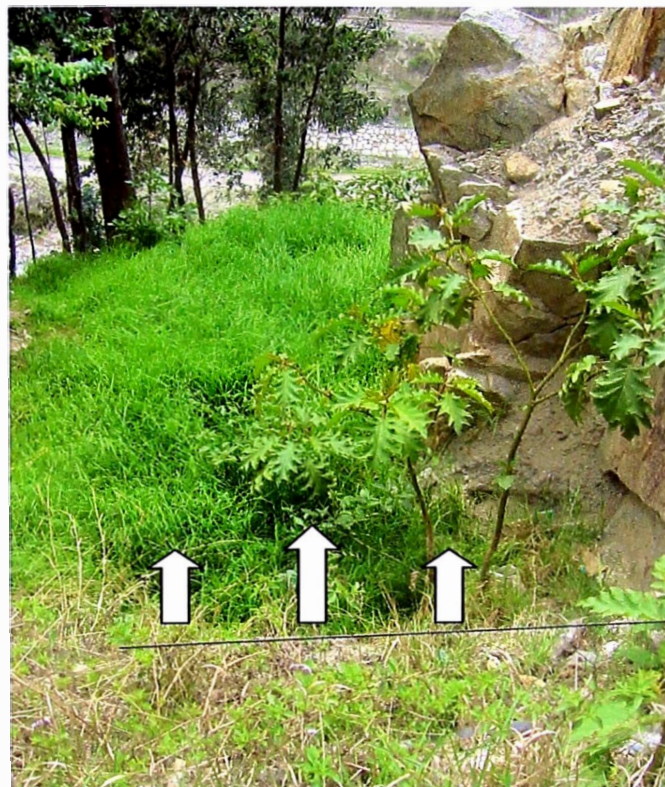
B.2.6 Salida de Alcantarilla con presencia de vegetación, Km. 68+497.
