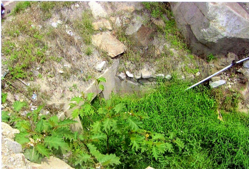
B.2.3 Salida de Alcantarilla colmatada, Km. 67+960.
