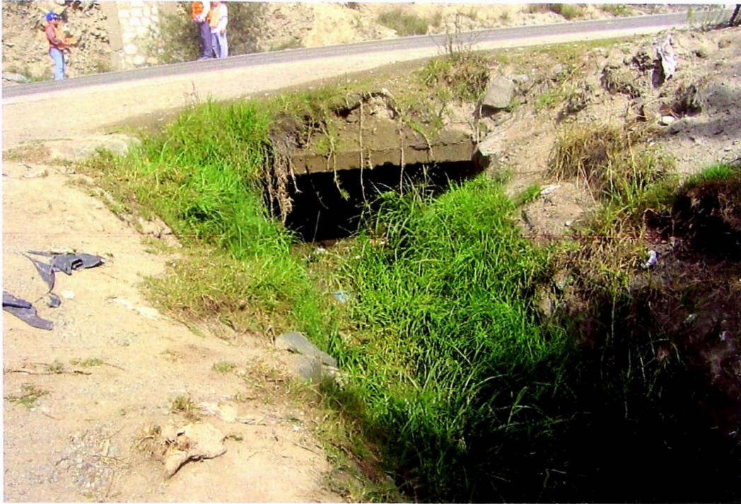
B.2.13 Alcantarilla parcialmente obstruida, presencia de vegetación a salida, Km. 69+520.
