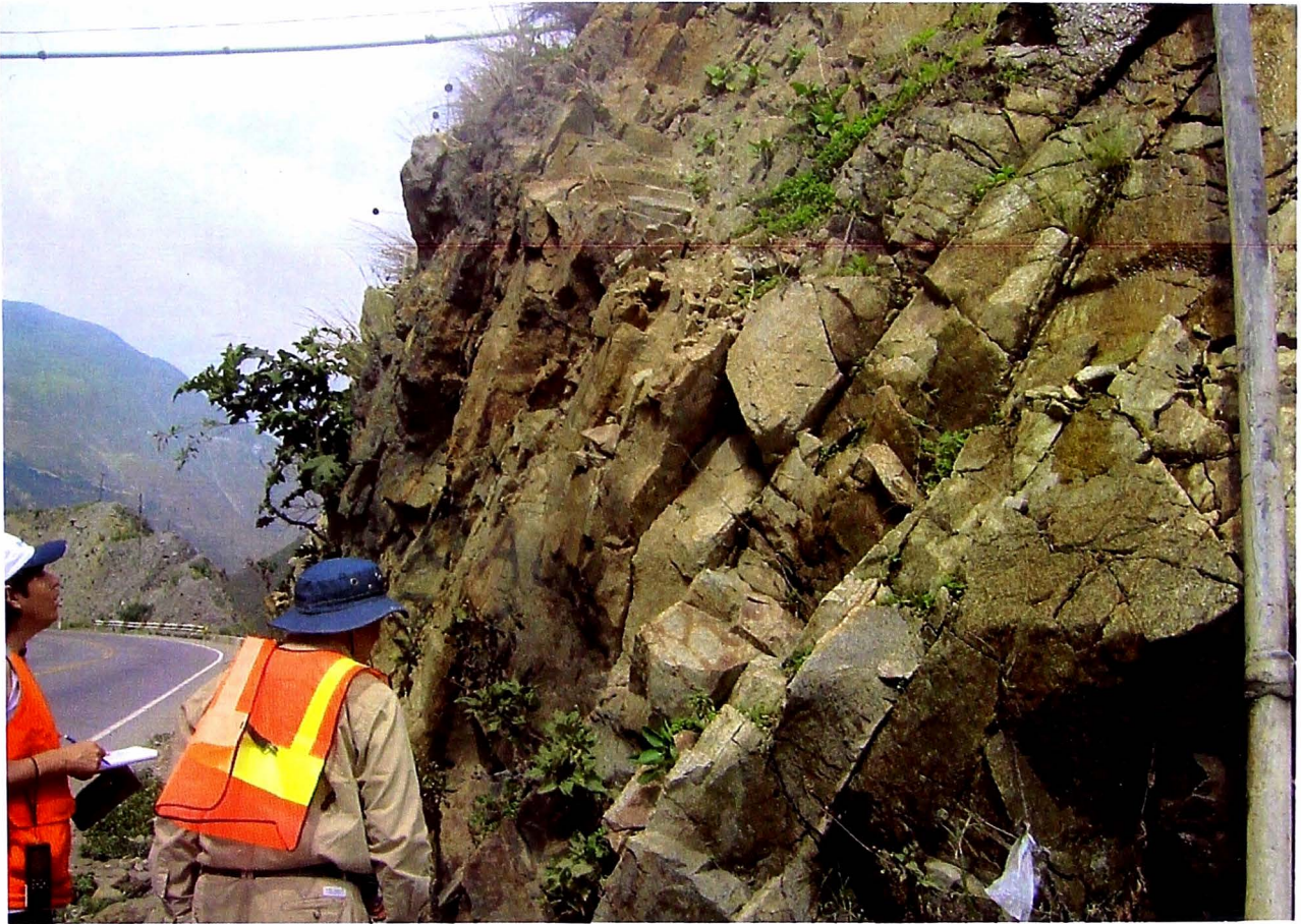
Km 68+250 Roca Intrusiva se aprecia distancia de fracturas entre 30cm a 50cm talud de 70%
