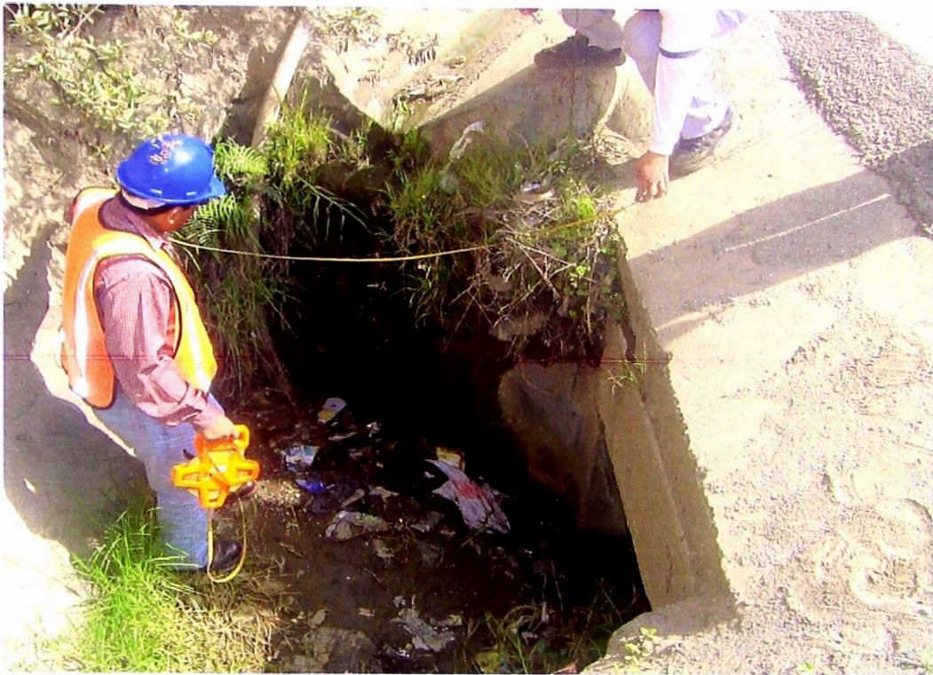
B.2.11 Entrada en buen estado, obstruida parcialmente presencia de basura, Km. 68+913.
