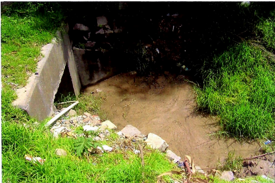
B.2.8 Salida obstruida en un 50%, Km. 68+710.
