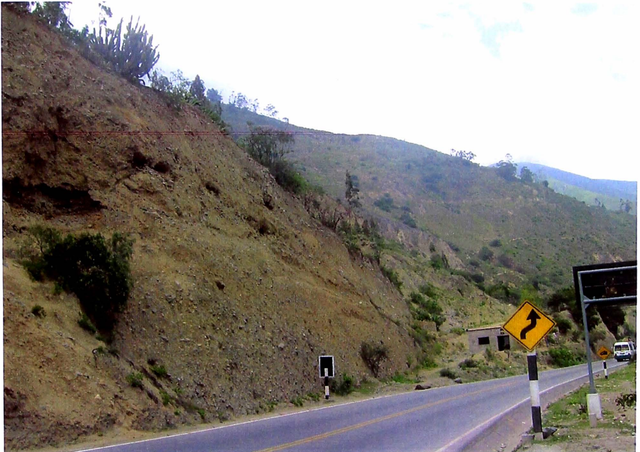
Km 69+450 Deposito aluvial se aprecia talud con pendiente 75%
