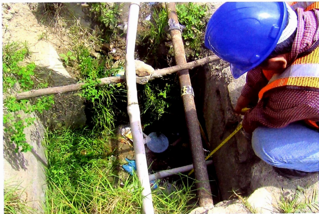
B.2.2 Ingreso de Alcantarilla ligeramente obstruido con presencia de tuberías artesanales, Km. 67+960.
