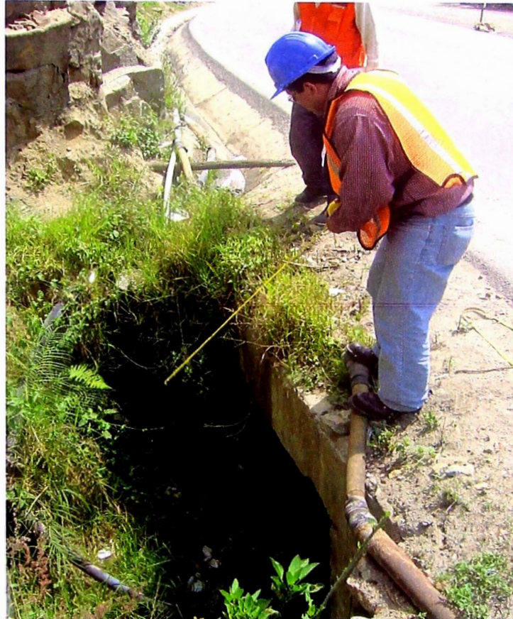
B.2.7 Buzón parcialmente obstruido con presencia de vegetación y tuberías de instalaciones clandestinas de agua, Km. 68+710.
