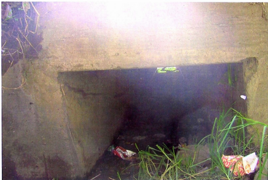
B.2.12 Presencia de basura y algo de vegetación a salida de Alcantarilla, Km. 68+913.
