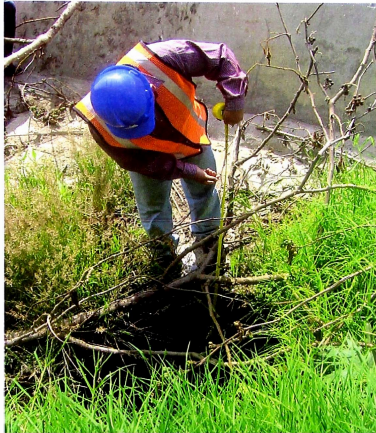
B.2.5 Salida de Alcantarilla totalmente colmatada, Km. 68+340.
