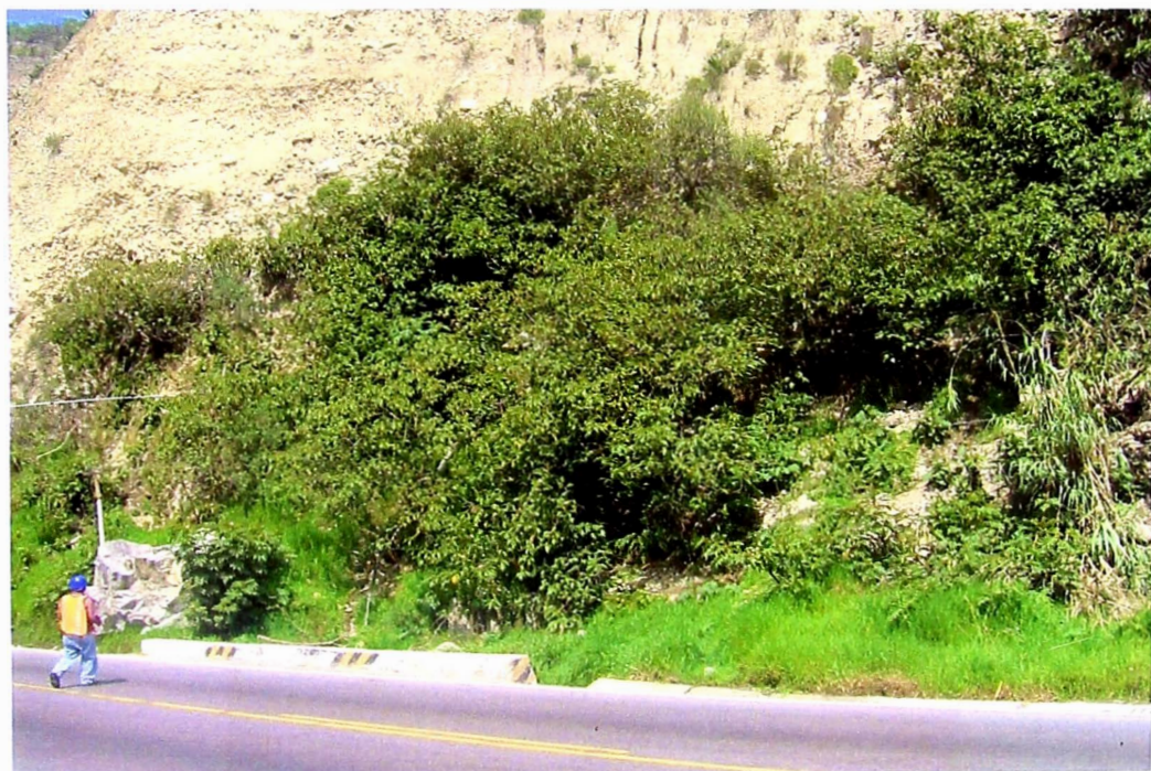
B.2.4 Alcantarilla a pie de quebrada artificial (generada por instalaciones clandestinas de agua), totalmente colmatada, Km. 68+340.
