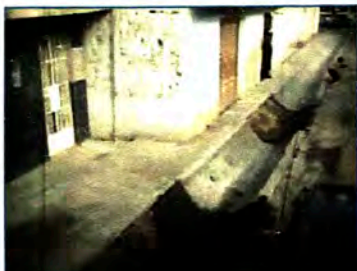
Se observa disminución del ancho de vereda que dificulta el paso de peatones, teniendo algunos que transitar sobre las cunetas, debido a la vivienda que no ha cumplido con su retro convenido en el Plan de Compensación y Resentamiento Poblacional, implementado antes del inicio de obra.
