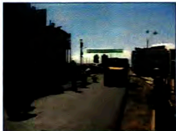
Durante la etapa constructiva se observó que los frentes de trabajo no fueron delimitados, principalmente aquellos con mayor afluencia de población como es la Plaza de Armas de Huayucachi, pudiendo haberse originado accidentes laborales, durante las diversas actividades en esta zona.
