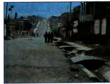
La presencia cercana y continua de pases vehiculares pueden ocasionar obstrucción de las cunetas al disminuirse su sección, incrementándose con prácticas impropias de la población por arrojamiento de desechos, no cumpliendo con su labor de evacuación de aguas pluviales.
