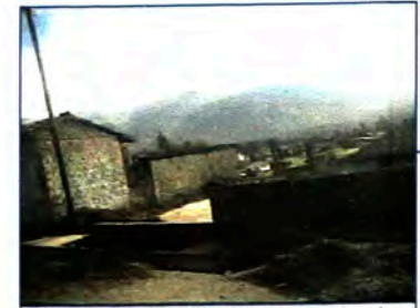
Al elevarse la plataforma de la vía siguiendo el mejoramiento de la carretera, se ha presentado el problema de viviendas que han quedado a desnivel de esta, pudiendo ocurrir accidentes, requiriendo la construcción de muros para su protección; así como escaleras para su acceso.
