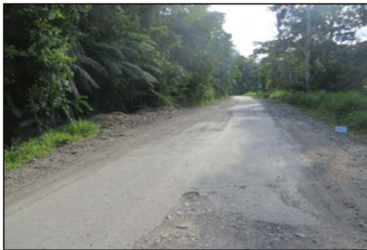
Km 04+300, Se observa desprendimiento de agregados, presencia de baches, carencia de drenajes
