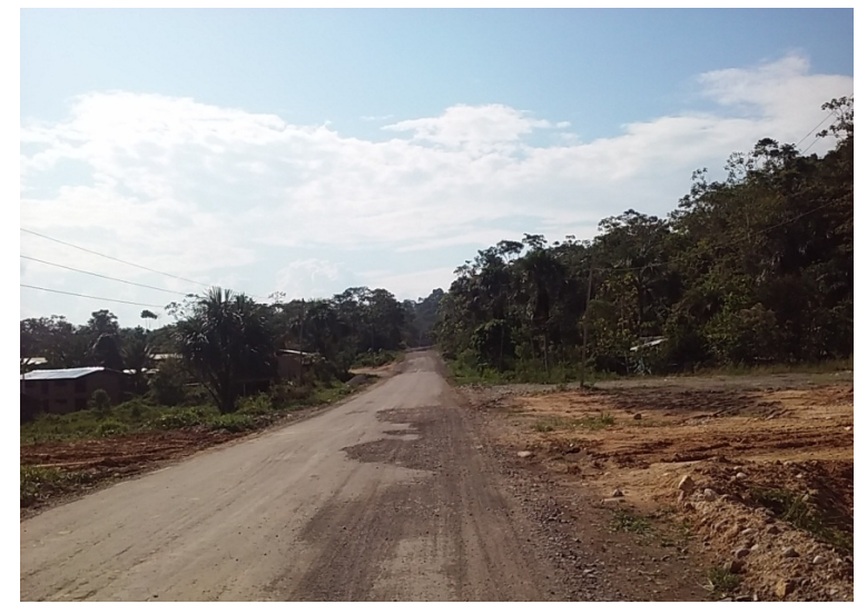
Km 35+100, se observa ahuellamiento, baches y agregados sueltos, presencia de humedad.
