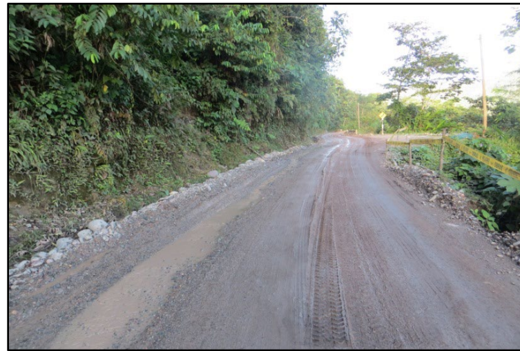
Km 41+900 – plataforma con problemas de humedad por aguas estancadas
