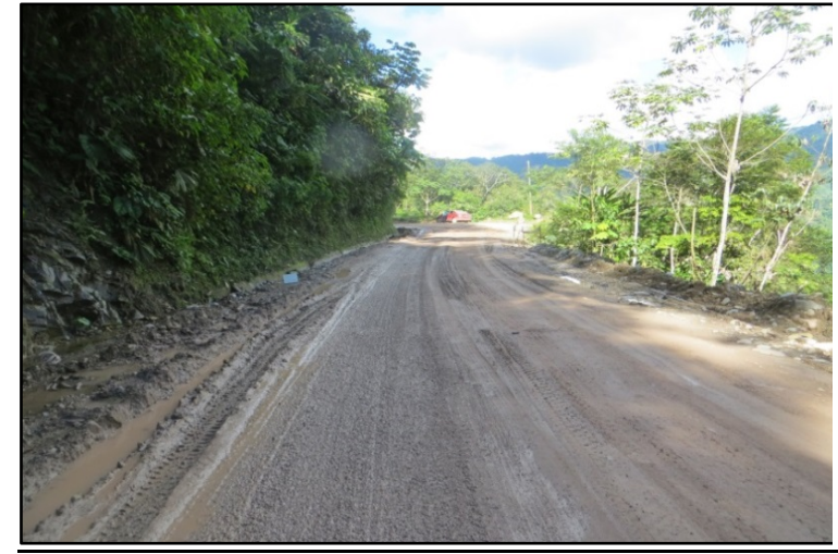
Km 43+000 - la plataforma en su totalidad se encuentra afectada por problemas de drenaje
