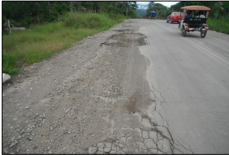
Km 03+500, se observa el estado deteriorado de la vía
