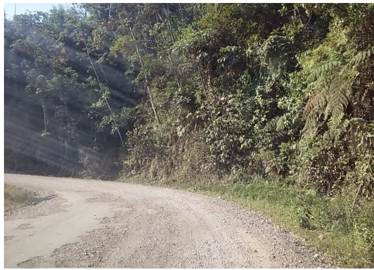
Km 10+020 - Se observa ahuellamiento, baches y agregados sueltos
