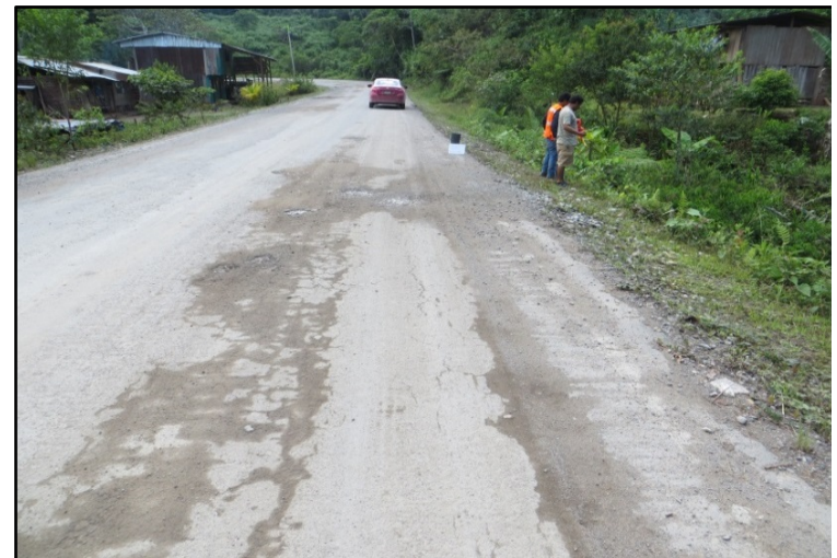
Km 09+850, Se observa defectos en la superficie, presencia de hundimientos longitudinales.
