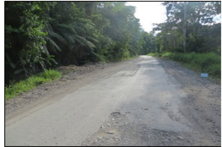
Km 04+300, Se observa desprendimiento de agregados
