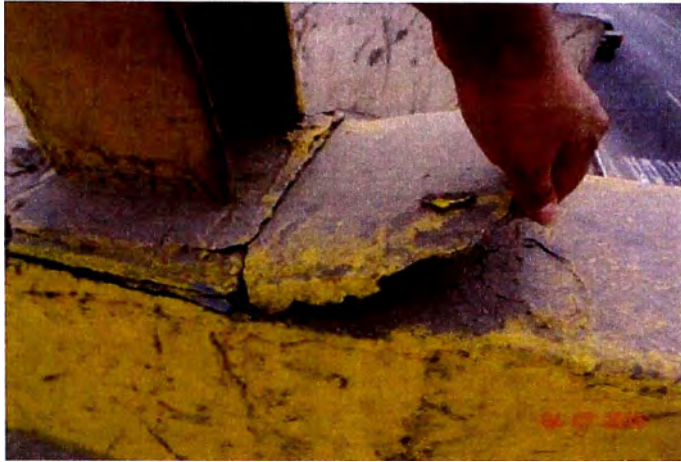
Figura 49.-Desprendimiento del concreto en la base de la baranda.
