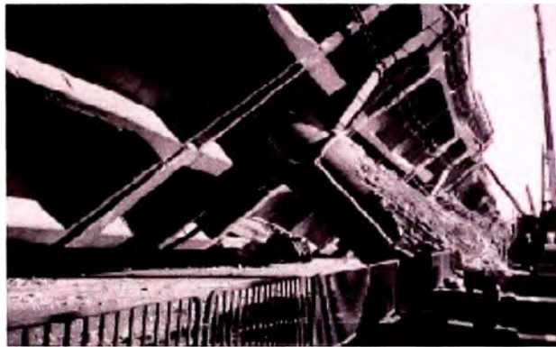
Figura 16.-Falla por flexión arriba de la base de la columna debido a una terminación prematura del refuerzo y un inadecuado confinamiento (Viaducto de Hashin- Japón, sismo de Kobe 1995).
