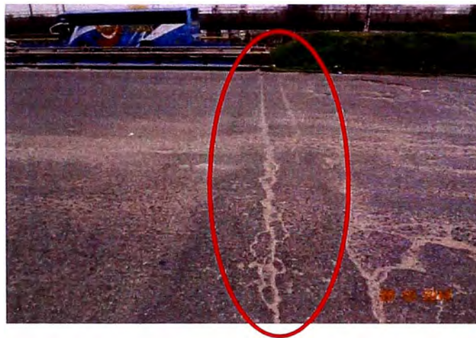
Figura 50.-Obstrucción en las juntas de dilatación.
