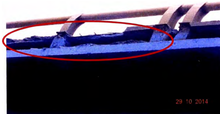
Figura 47.-Corrosión y pérdida de sección en el parapeto Fuente: Elaboración propia
