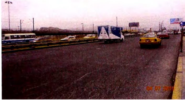
Figura 46.-Deterioro en la carpeta asfáltica del puente Atocongo Fuente: Elaboración propia
