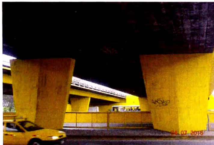
Figura 54.-Presencia de eflorescencia y evidente deterioro en la parte inferior de la viga cajón.
