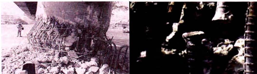
Figura 15.-Falla de la soldadura empleada para el empalme de varillas en la zona de articulación plástica (autopista de Hashin- Japon, sismo de Kobe 1995).
