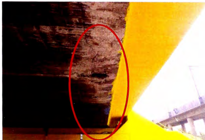
Figura 52.-Pérdida de sección y desgaste del extremo de la viga.
