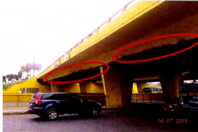
Figura 51.-Vista del deterioro severo en el extremo inferior de la viga cajón.
