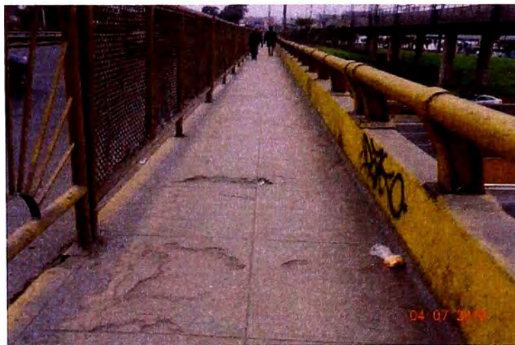
Figura 48.-Presencia de grietas y deterioro en veredas. Fuente: Elaboración propia
