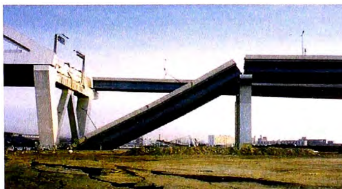
Figura 13.-Falla ocasionada por desplazamientos longitudinales excesivos.
