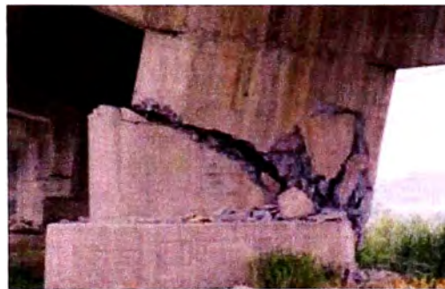
Figura 17.-Falla por cortante en columna de un puente, (Taiwán, 1999).
