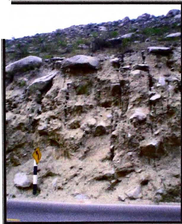
FOTO N° 04. -Esguimientos sobre las laderas provocan inestabilidad en los taludes generando desprendimiento.
