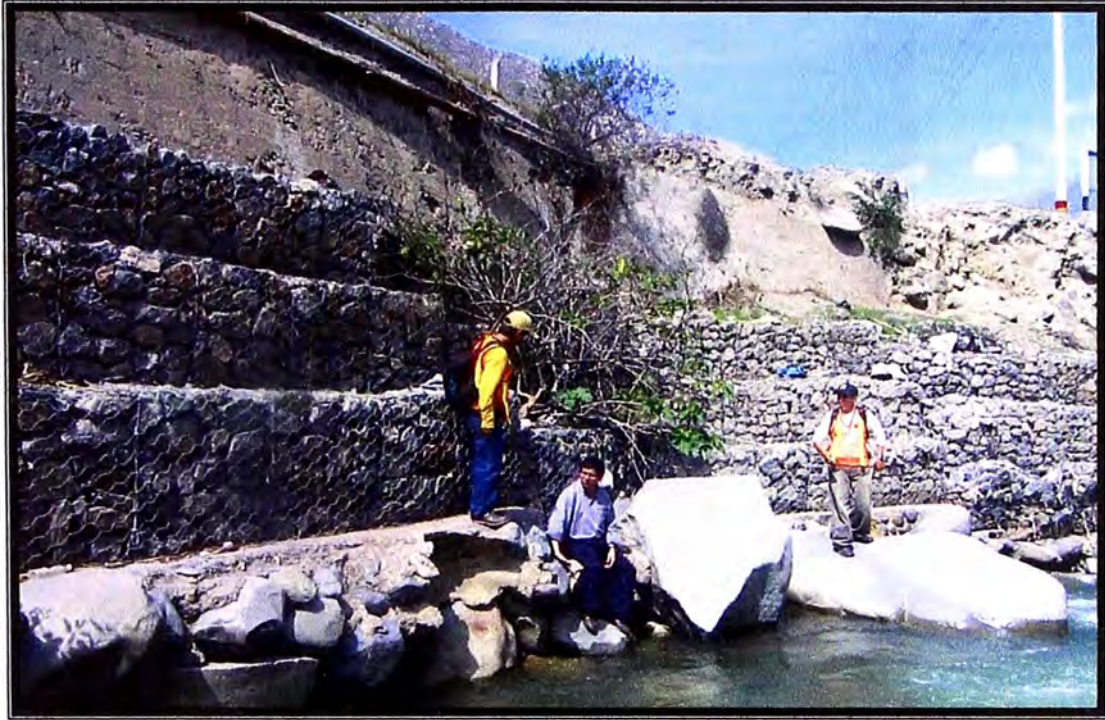
FOTO N° 11. -Se observa la socavación existente en la base cimentación de gaviones, que serán demolidos y remplazados por otra base de cimentación con enrocado (Km. 64+670 lado izquierdo de la vía).
