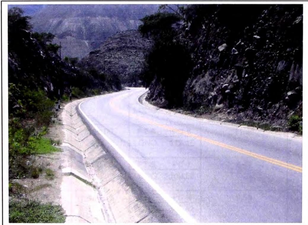
FOTO 2.2 SE OBSERVA LA EXISTENCIA DE UNA CURVA REVERSA
