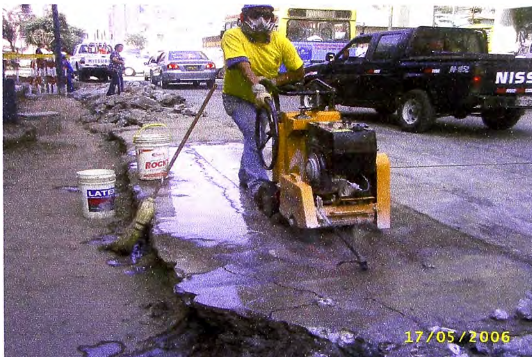
FOTO 3 : CORTADORA DE PAVIMENTO EN LA OBRA REHABILITACION DE LA AV. ARENALES MAYO 2006
