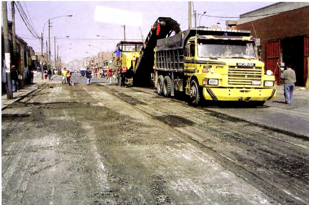
FOTO 1 Y 2 : FRESADO DE LA CARPETA ASFALTICA EXISTENTE DE LAS CALLES ALEDAÑAS A LA AV. GRAU JUNIO 2006
