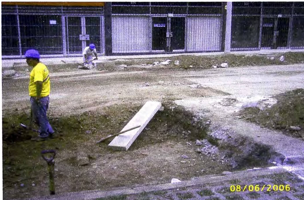
FOTO 8 : PERFILADO DE LA OBRA EN LA OBRA REHABILITACION DE LA AV. ARENALES JUNIO 2006
