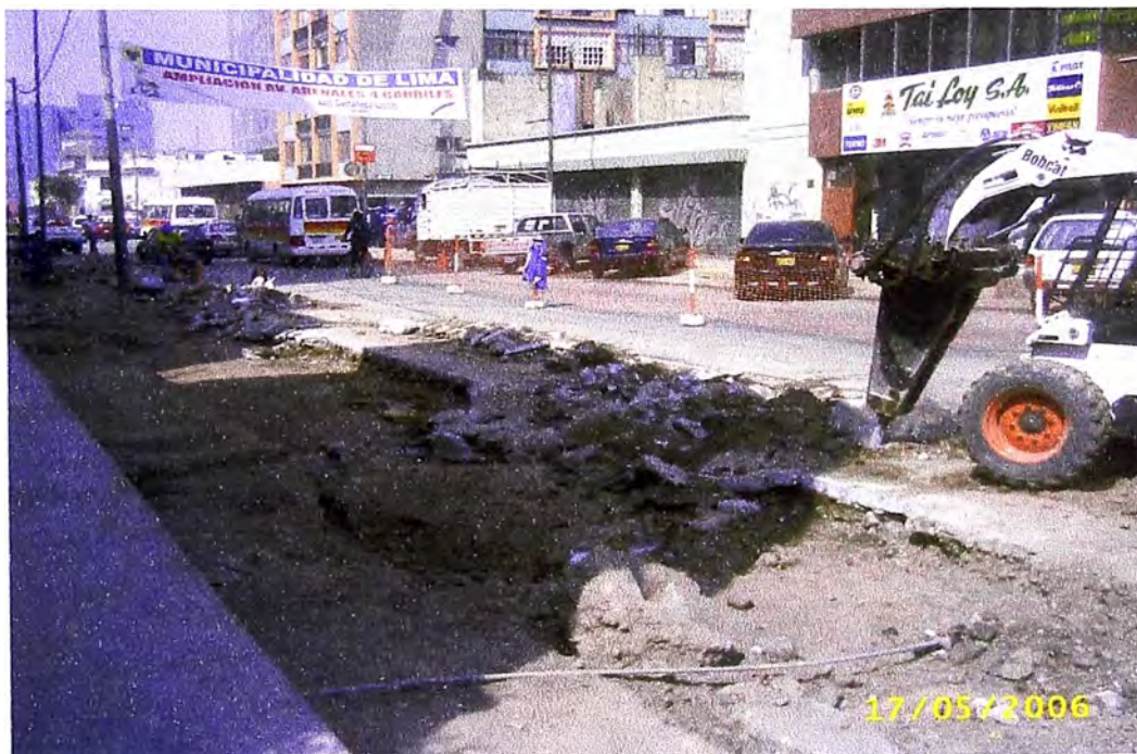
FOTO 4 : RETIRO DE LA CARPETA ASFALTICA DETERIORADA POR MEDIO DEL BOBCAT EN LA OBRA REHABILITACION DE LA AV. ARENALES MAYO 2006
