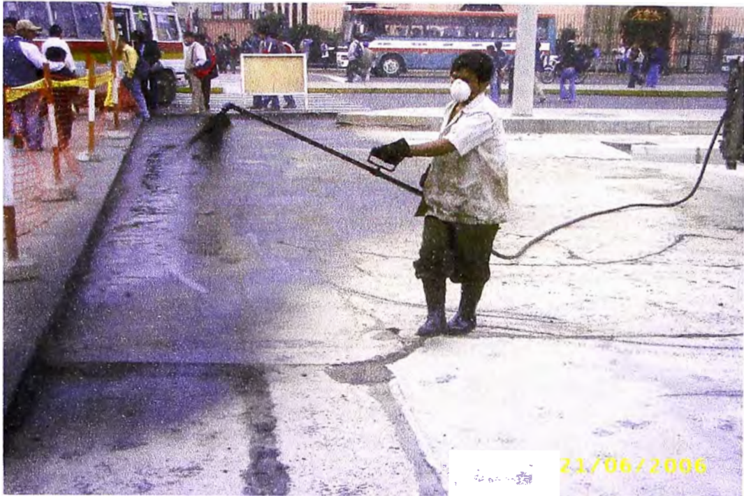
FOTO 13 : IMPRIMACION MEDIANTE EL ESPARCIDOR MANUAL DEL CAMION IMPRIMADOR EN LA OBRA REHABILITACION DE LA AV. ARENALES
