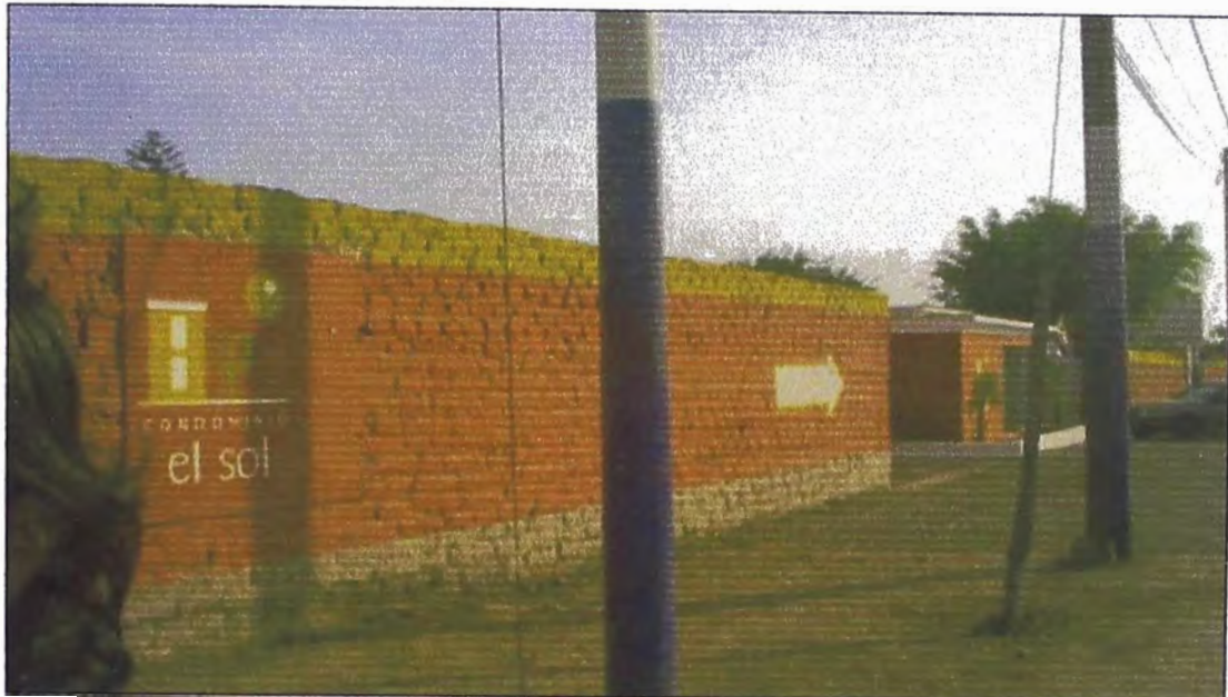
Ilustración A.5: Condominio en construcción EL SOL (Av. El Sol con Av. Los Gorriones)
