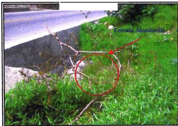
El ingreso se ve cubierto con vegetal, Falta limpieza
