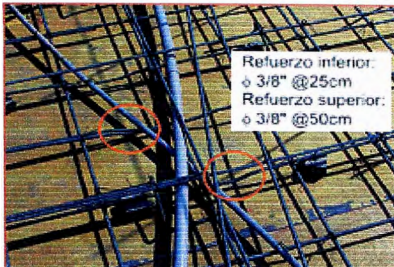
Fig. 1.17 - Falta de linealidad de tuberías debido a la saturación de tuberías
