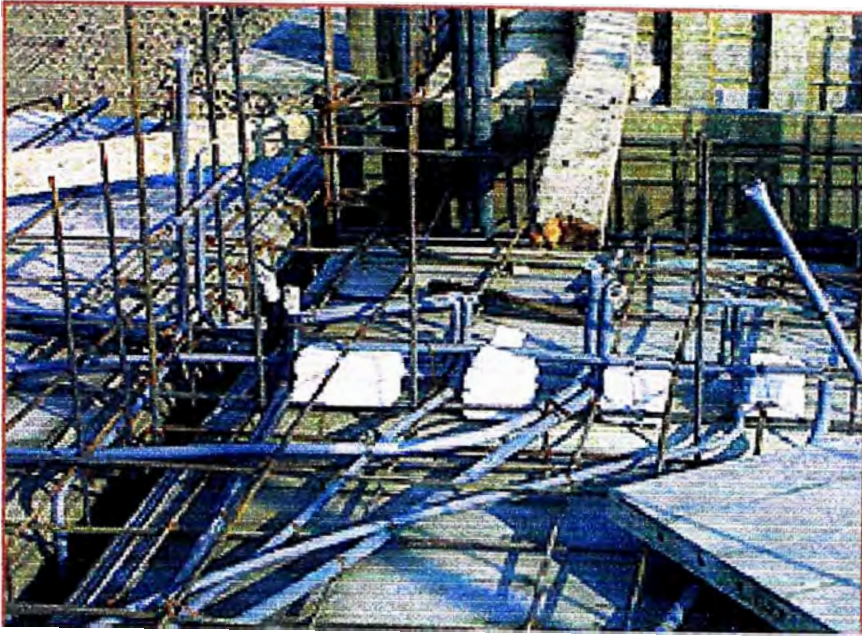
Fig. 1.48 - Saturación de Tuberías Eléctricas en Losa
