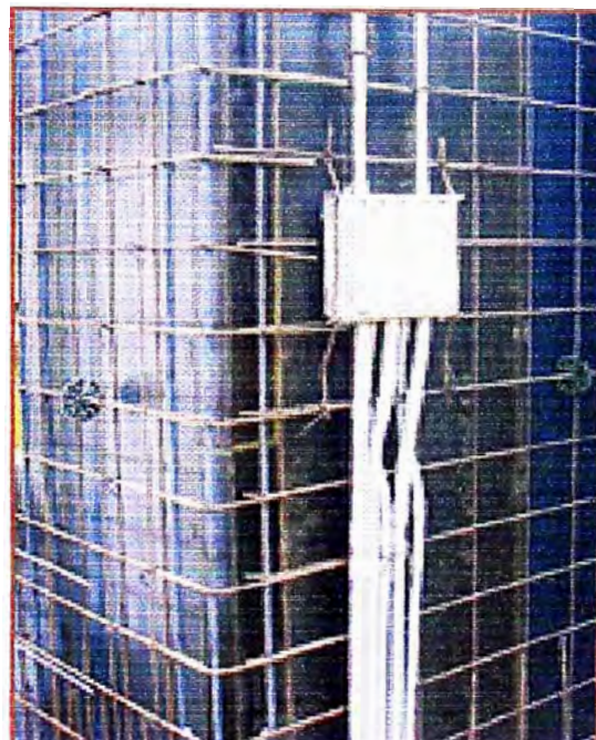
Fig. 1.25 - Falta de Continuidad en el muro por paso de tuberías
