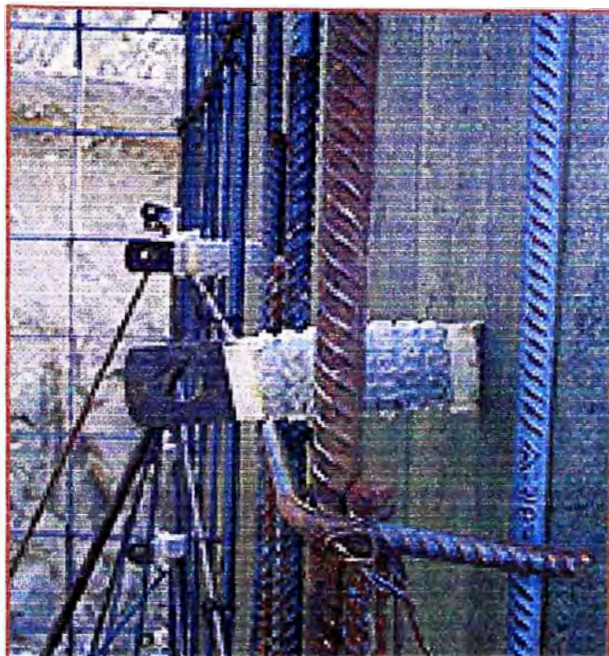
Fig. 1.42 - Corbatas de amarre del encofrado metálico
