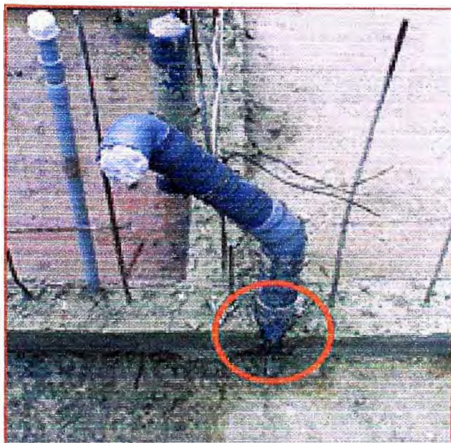
Fig. 1.27 - Falta de Recubrimiento de tuberías (no cumple con las normas)
