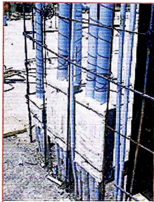
Fig. 1.33 - Saturación de cajas Eléctricas en Muros
