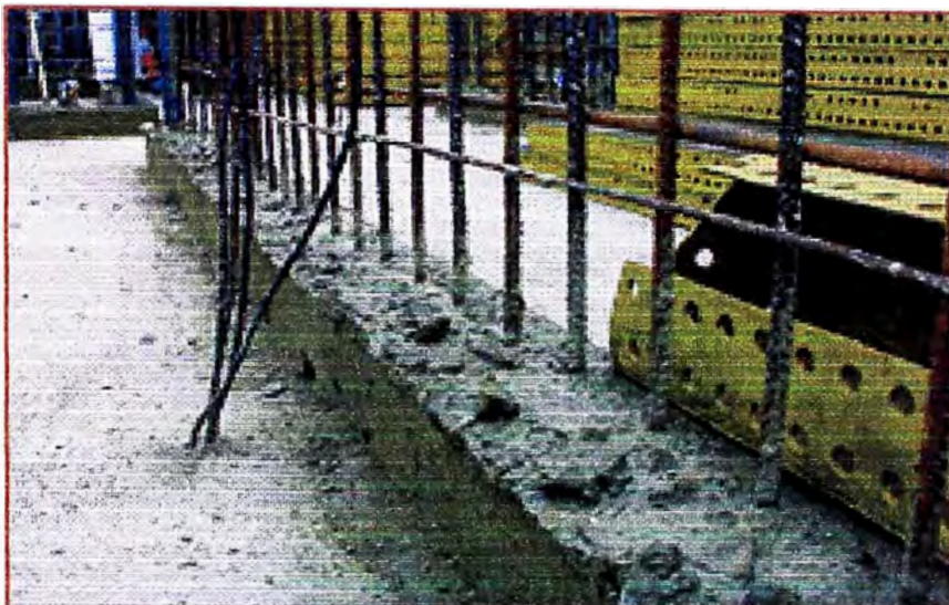
Fig. 1.37 - Mal tratamiento previo para facilitar la colocación del encofrado
