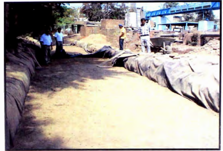
FOTO N° 06 Nivel de subrasante con material degradado
