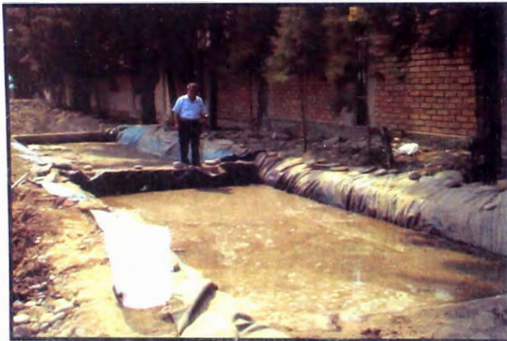
FOTO N° 07 Saturación de la subrasante degradada
