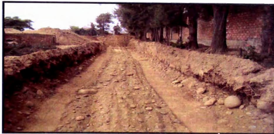
Fig. 11- 11 Vista parcial de la excavación se aprecia el suelo granular del fondo
