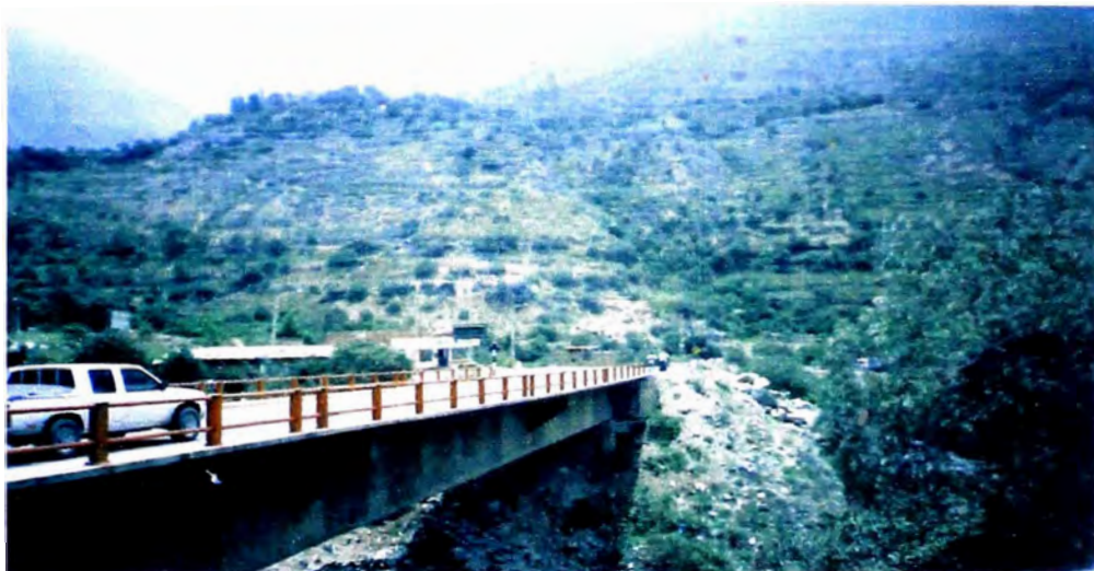
Foto N° 10: Pavimento sobre el Puente Surco Km. 66+000 Luz de 62.00 m, altura del Desvió hacia San Jerónimo de Surco.
