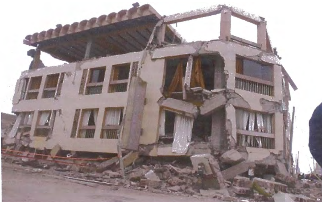
Figura 4.7.1.b Vista del Hotel Embassy luego del colapso
