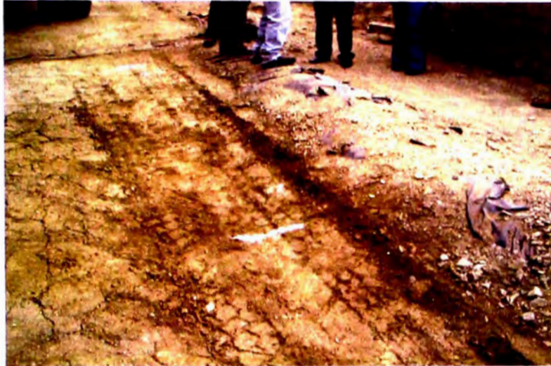
Fig. 4.9 Estado del pavimento reforzado con geoweb una vez culminada la prueba
