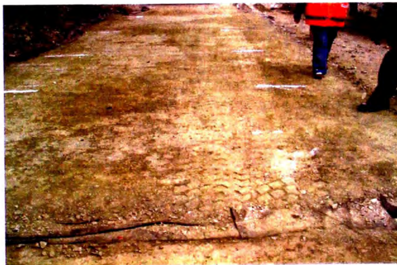
Fig. 4.8 Estado del pavimento reforzado con geotextil una vez culminada la prueba.
