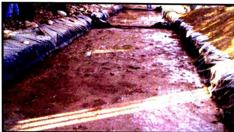
Fig. 2.23 Vista del suelo degradado con CBR igual a 0.7 %.
