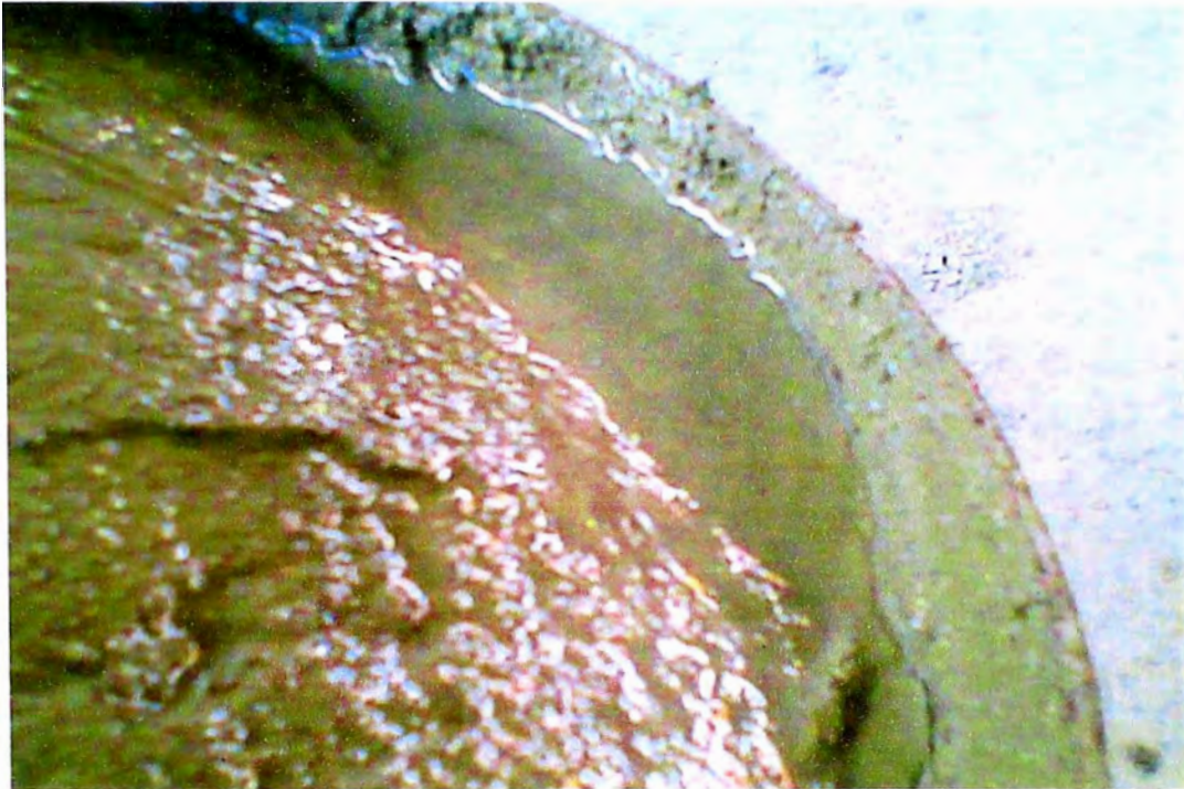
Exudación del concreto
