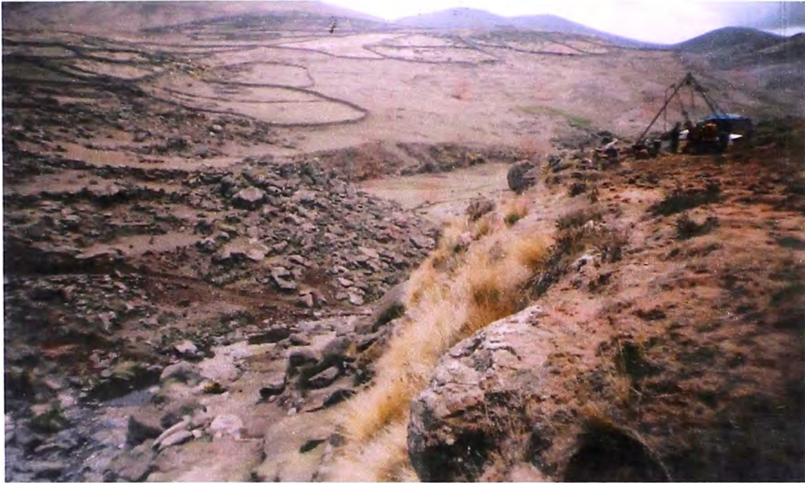
Foto 11: Vista de la boquilla de Presa Vizcachani y el equipo de perforación en el estribo izquierdo.
