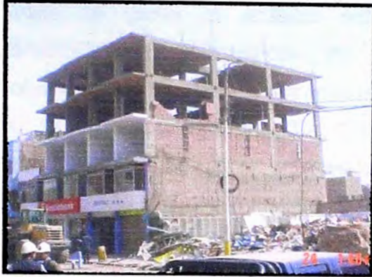
Fig. 3.- Mala práctica Constructiva
