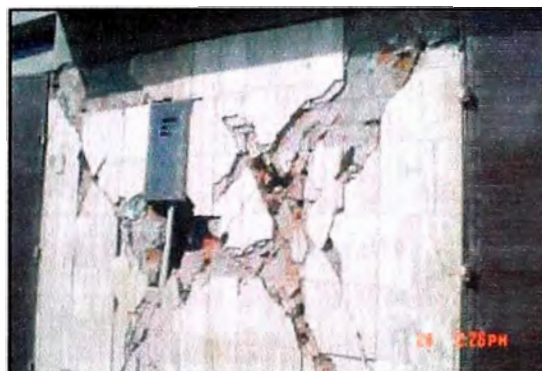
Fig. 2.- Mala Calidad del ladrillo
