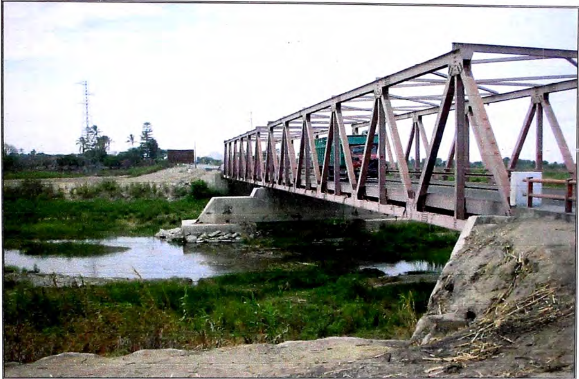
Foto 3: Puente Reque actual tipo reticulado metálico, conformado por dos tramos de 50 m cada uno. Fue construido en el año 1998 como reemplazo del puente antiguo colapsado.
