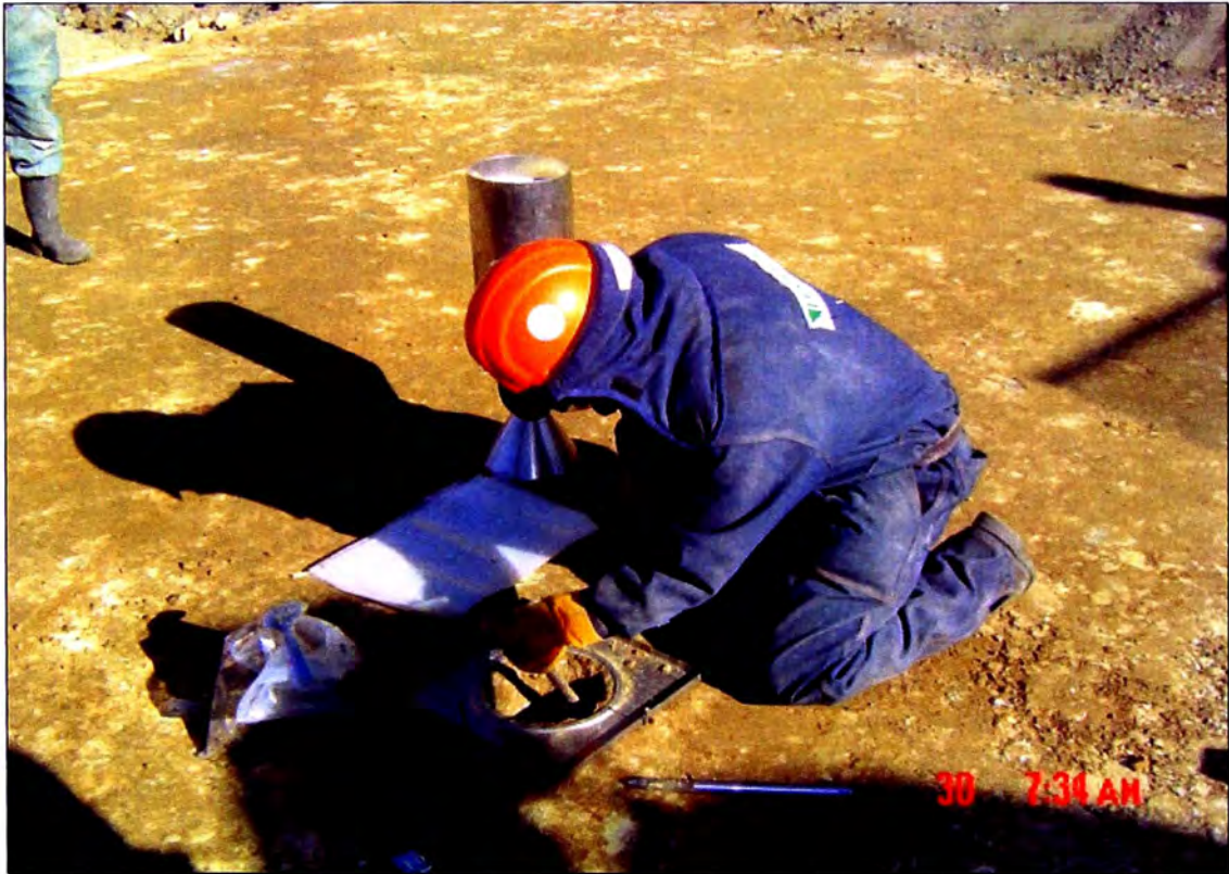
Foto N° 5: Excavación del hueco en la capa de terraplén compactada para la realización del ensayo de control de densidad con el método del cono de arena.
