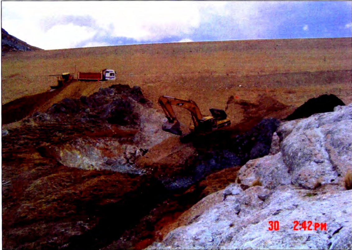
Foto N° 7: Excavación y acopio de suelo orgánico para eliminación, al pie de talud aguas abajo de la Presa Explorador, entre las prog. 0+110 a 0+135 aproximadamente.
