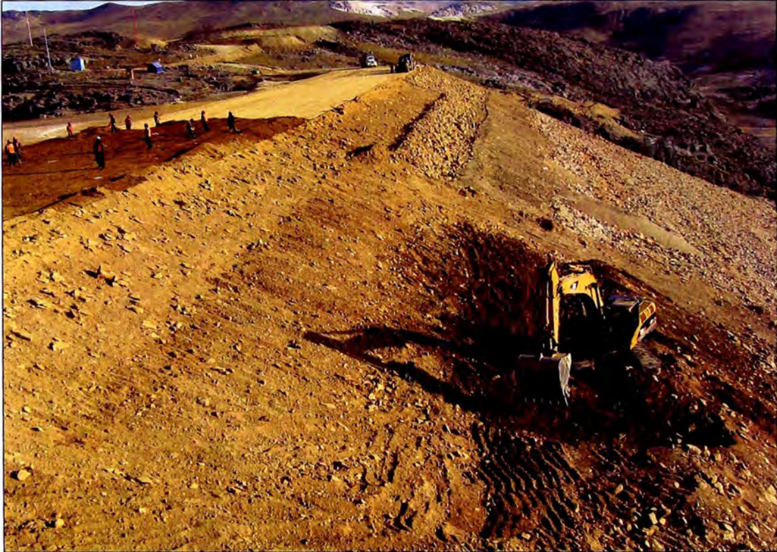
Foto N° 16: Perfilado y peinado del talud aguas abajo del recrecimiento de la Presa Explorador.
