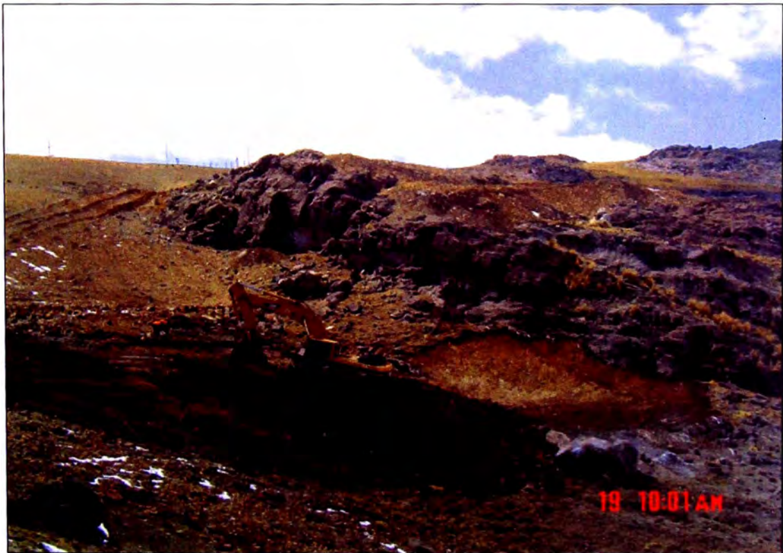
Foto N° 2: Excavación y acopio del suelo no apto para cimentación de la Presa Explorador, ubicado al pie de talud aguas abajo, entre las prog. 0+140 a 0+190 aproximadamente).
