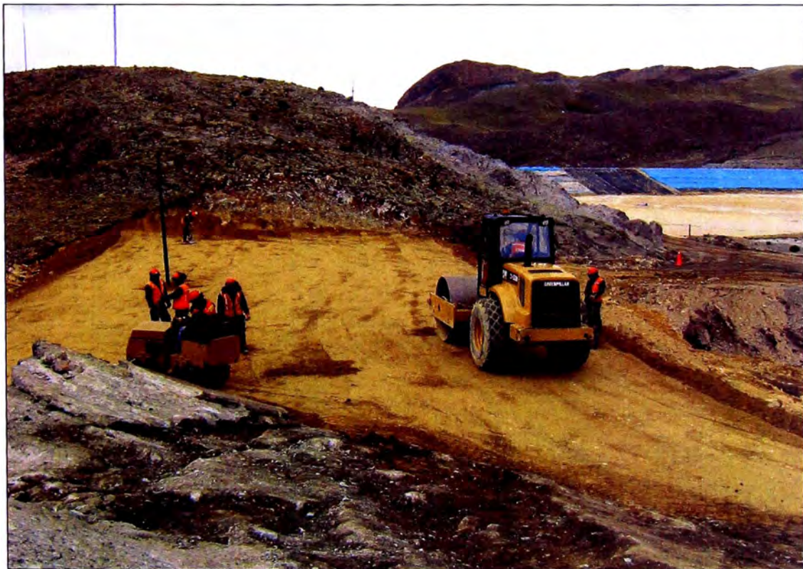
Foto N° 21: Compactación de una capa de relleno de la Presa Lateral N° 1. Obsérvese la extensión del piezómetro BH-02-06 (PZ-03).
