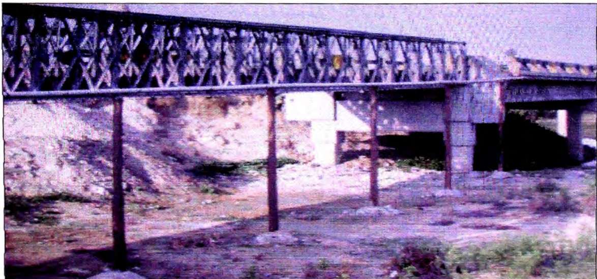
Figura 2.2 Foto del Puente, se observa la estructura metálica a ser cambiada
