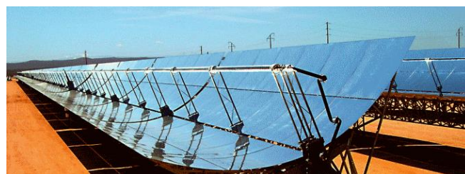
Figura 3. Arreglo de concentradores solares cilíndrico parabólicos
