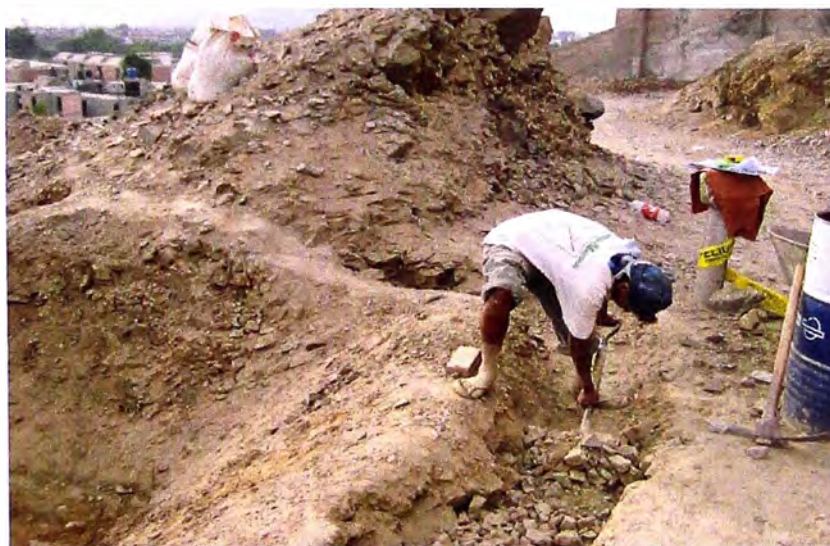
Foto N° 7 Presencia de rocas al costado de la excavación. Mejores condiciones de estabilidad.
