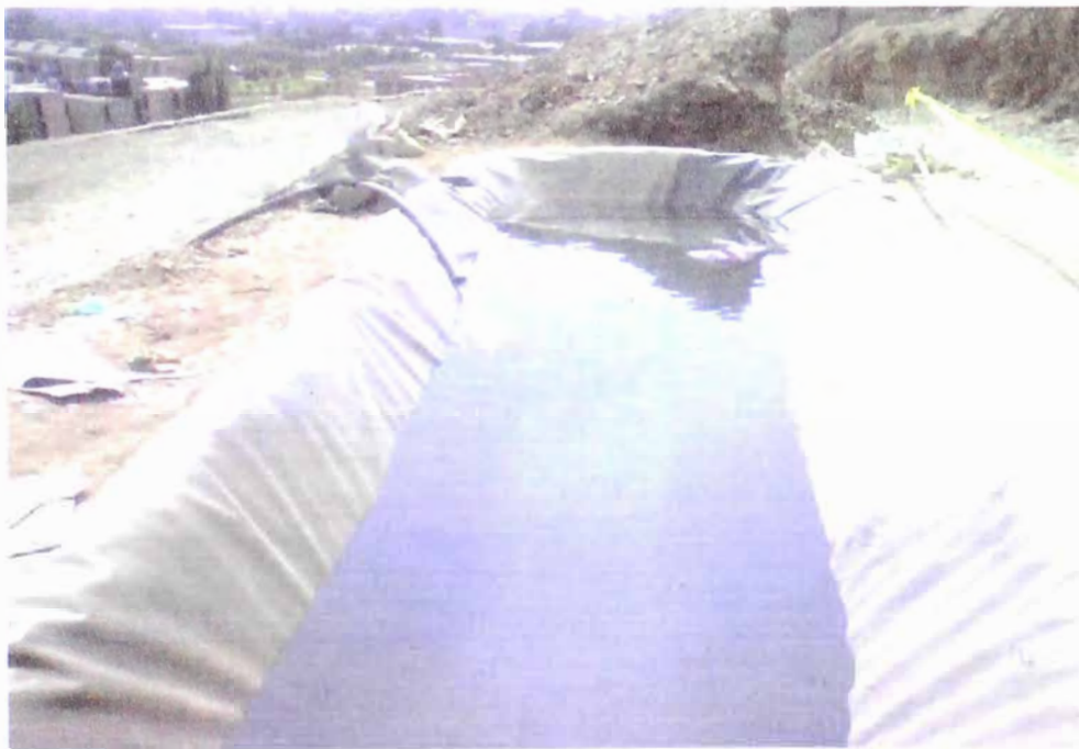
FOTO 8: En esta vista se aprecia la poza llena de agua.
