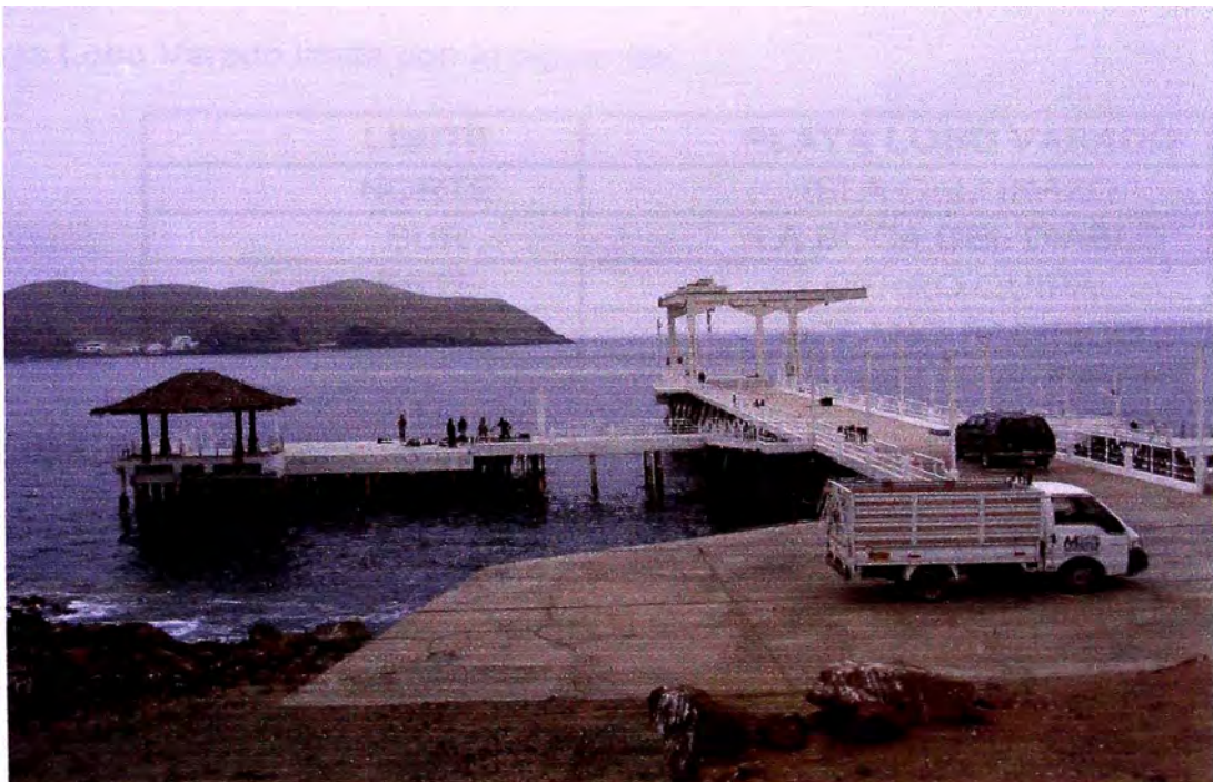
FIG. N° 02: Estado actual del muelle “El Poseidón”
