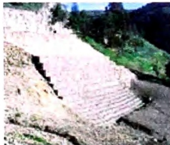
Imagen 1.4 Sistema Terramesh, Cajamarca, Perú.
