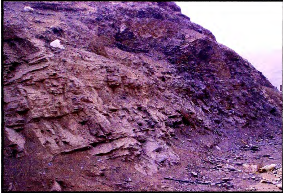
Foto N° 09: Vista del macizo rocoso, nótese la dirección de las discontinuidades, en sentido contrario a la inclinación del talud.
