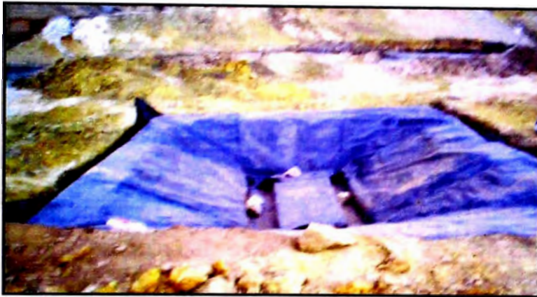
Foto N° 3.13 Colocación de lastres para evitar que la geomembrana instalada se mueva, y así no se forme pliegues.
