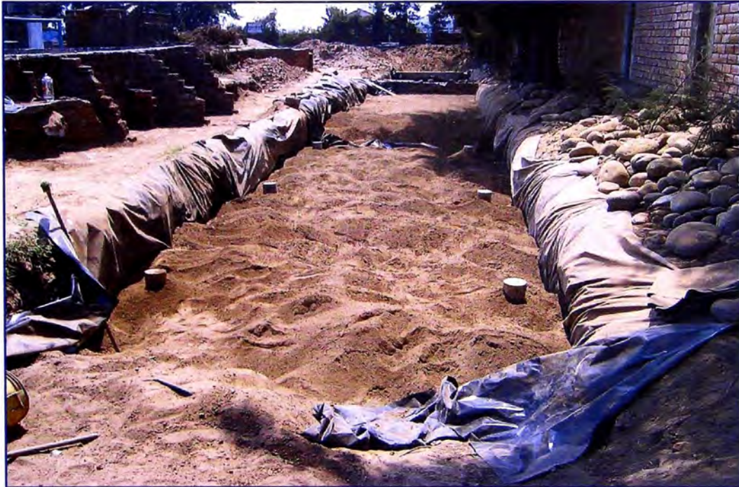
Figura 4.5: Emplantillado espesor del suelo degradado 0.65m.
