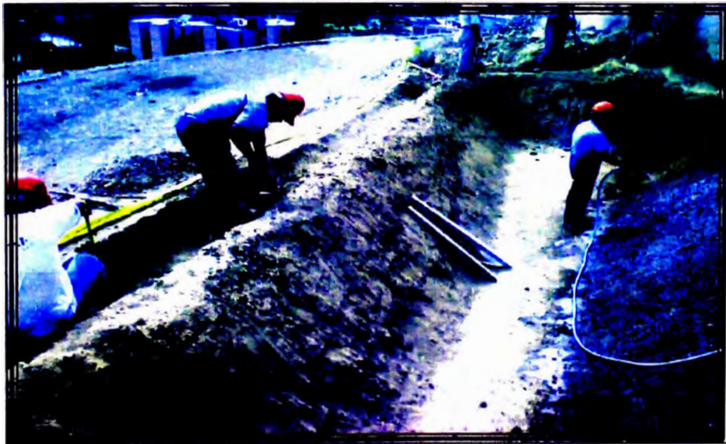
FOTO 02: En esta foto se aprecia la excavación que se esta realizando en la zanja donde va a anclar la geomembrana.
