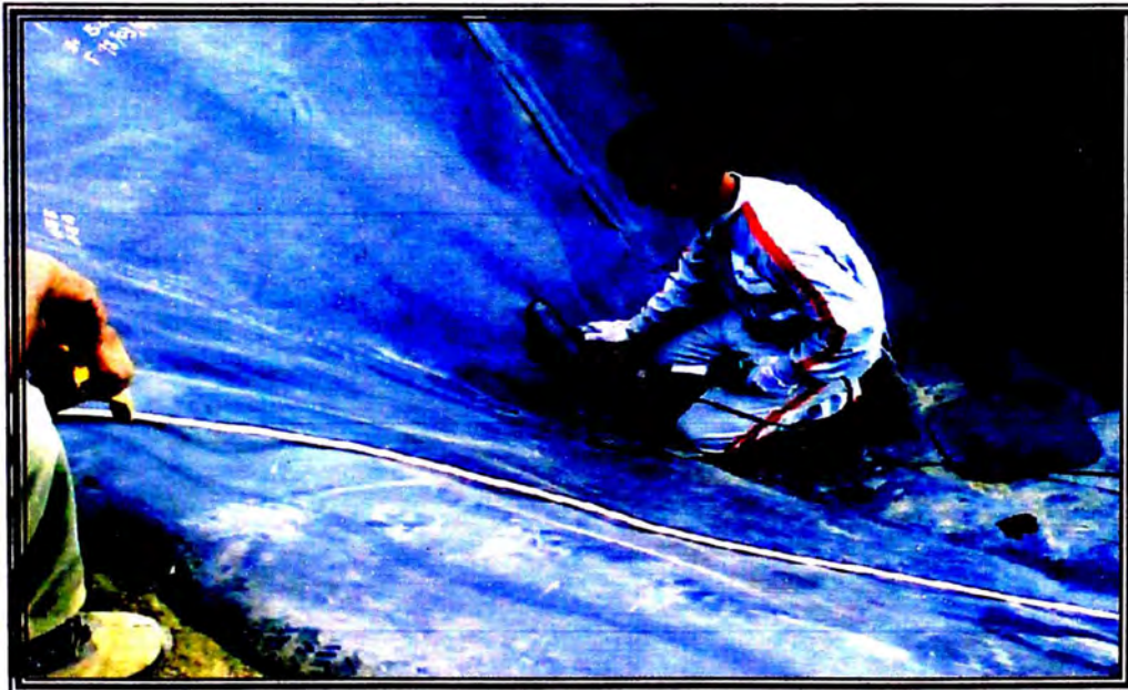
FOTO 06: En esta foto podemos apreciar la tubería de desfogue de la poza de agua.
