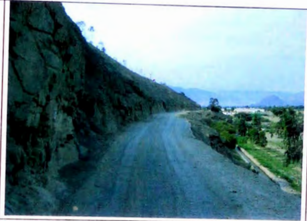
FOTO N° 38 Roca fija intercalada con roca suelta en borde derecho de carretera, altura de banco 4 m, 80° de talud en tramo 14+580-14+710
