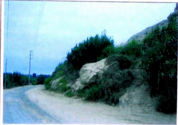
FOTO N° 26 A 2 m. de borde derecho, roca fija altura de banco 4 m. 50° de talud con rodados y bolonería en ladera de cerro en tramo 12+110-12+260
