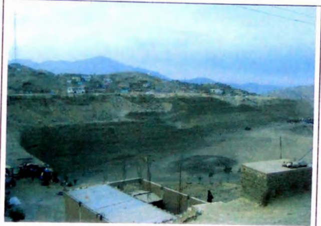
FOTO N° 02 Tramo de carretera se encuentra sobre corte dejado como pilar de 13 m, de altura producto de extracción de agregados de cantera, en tramo 00+100-00+500
