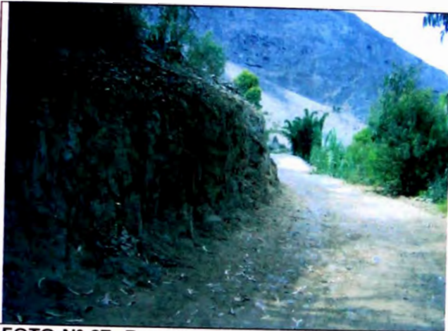
FOTO N° 37 Roca suelta intercalada con material suelto en borde derecho de carretera altura de banco 2 m, 80° de talud en tramo 14+300-14+450
