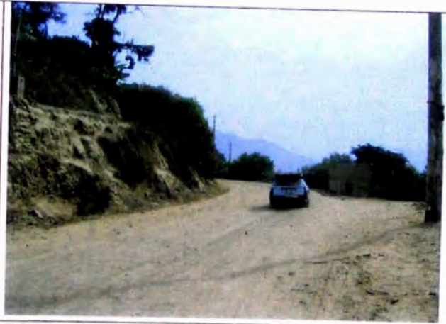
FOTO N° 02 Material suelto areno gravoso en borde izquierdo terraza de 3 m, de altura, 60° de talud en tramo 0+260-0+360
