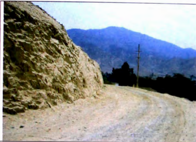
FOTO N° 13 A 2 m, de lado izquierdo afloramiento de roca fija fracturada de 3 m, de altura 55° de talud, en tramo 3+420-3+600
