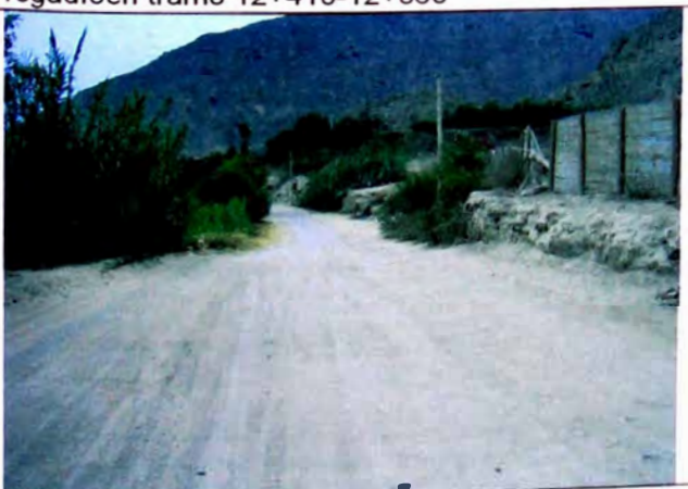
FOTO N° 29 Material suelto, en borde derecho carretera, alteración de roca fija, en tramo 12+810-12+935
