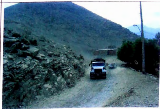
FOTO N° 12 En borde derecho roca fija fracturada, en borde izquierdo roca fija fracturada altura de banco 5 m. con 70° de talud en tramo 9+150-9+230
