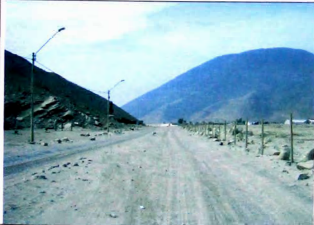
FOTO N° 09 En borde derecho cerco de alambrado granja carretera se encuentra por debajo de nivel original por erosión de tránsito vehicular en tramo 6+400-6+720
