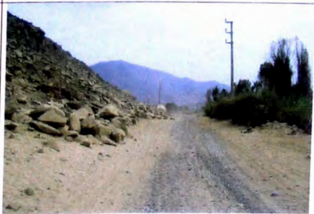
FOTO N° 06 Zona crítica material de derrumbe en borde interno, producto de alteración del intrusivo, clastos medianos y bolonería con matriz arenosa, en tramo 1+150-1+260
