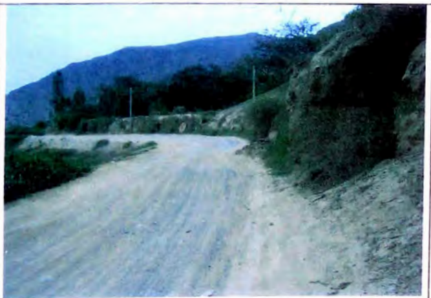
FOTO N° 28 En borde derecho terraza de material suelto ubicado a 2 m. de carretera, altura promedio 3 m, 80° de talud en tramo 12+560-12+720
