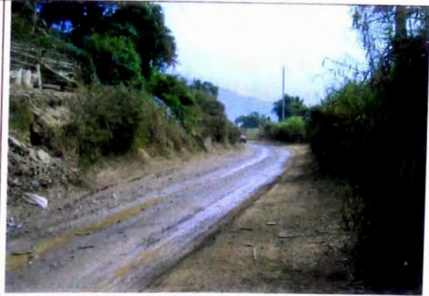
FOTO N° 04 En borde izquierdo terraza de material suelto 3 m, de altura, material areno gravoso, en tramo 0+440-0+640
