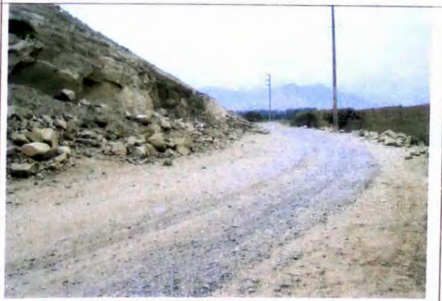
FOTO N° 16 A 4 m, de lado izquierdo de carretera material suelto depositado en ladera de cerro en tramo 4+280-4+380
