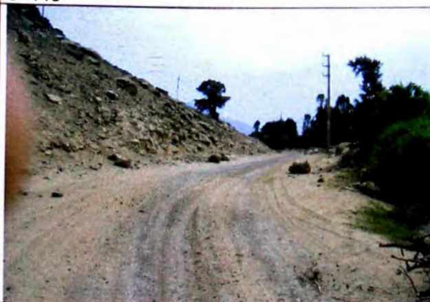
FOTO N° 05 Zona crítica Roca suelta con material suelto en borde interno, producto de alteración de roca fija, banco de 5 m, de altura 45° de talud, lastos de 10" y 15", bolonería tramo 0+880-0+980
