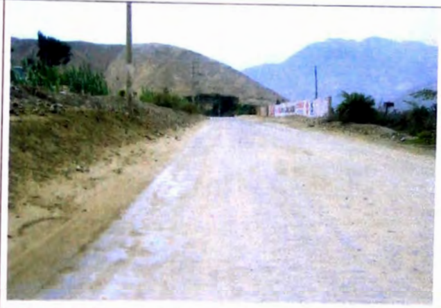
FOTO N° 14 A 3 m, de lado izquierdo material suelto intercalado con roca suelta, en tramo 3+600-3+820
