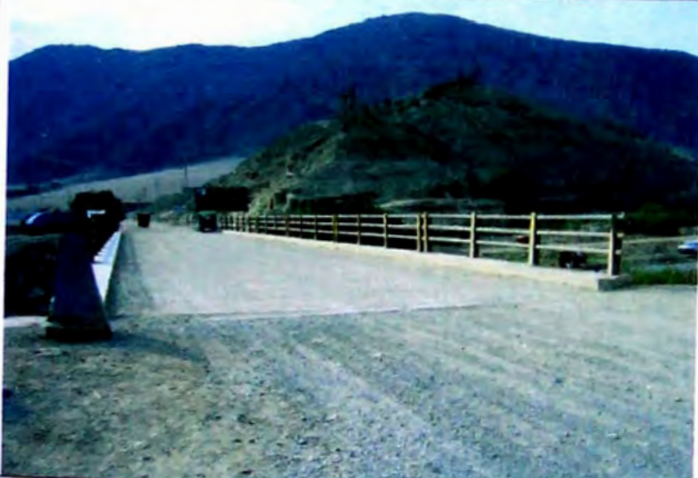
FOTO N° 39 PUENTE PACHACAMAC, por debajo discurre el río Lurín, Material suelto, en tramo 14+755-14+850
