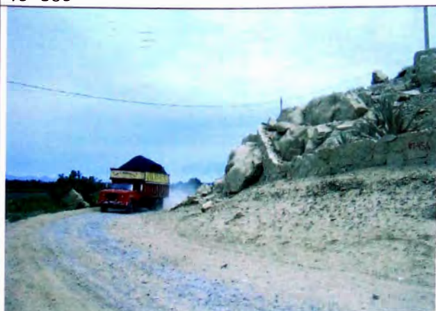
FOTO N° 23 A 2 m, de borde derecho afloramiento de roca fracturada, altura de banco 5 m, 65° de talud, en borde izquierdo terrenos de cultivo, en tramo 11+000-11+050
