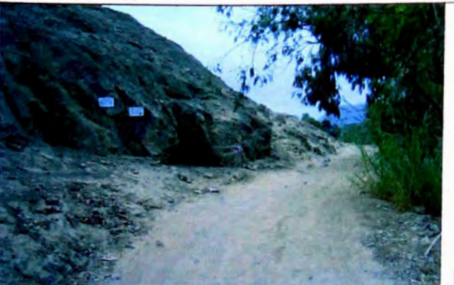
FOTO N° 35 Roca fija fracturada en borde derecho carretera 45° de talud, en tramo 13+780-13+820
