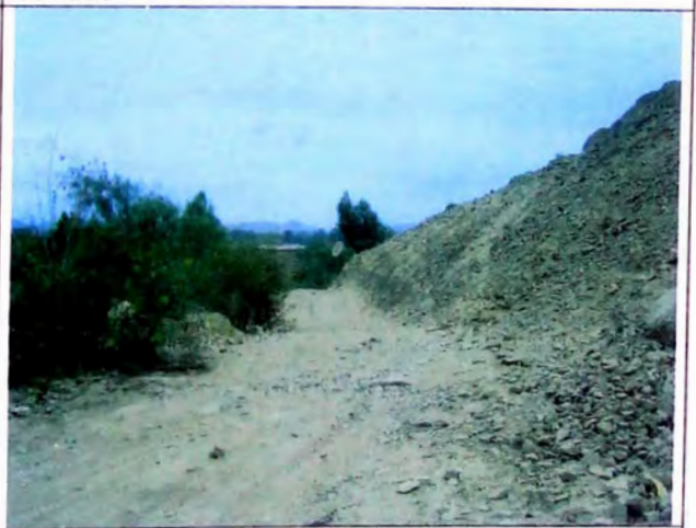
FOTO N° 34 Roca fija en borde derecho de carretera altura de banco 2 m, talud de ladera de cerro 45° en tramo 13+740-13+780
