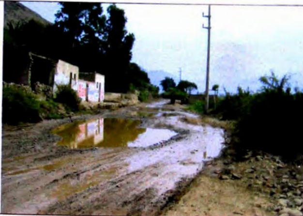
FOTO N° 03 En borde izquierdo viviendas, en borde derecho cerco de malla, agua en tramo producto desborde de canal en tramo 0+360-0+440
