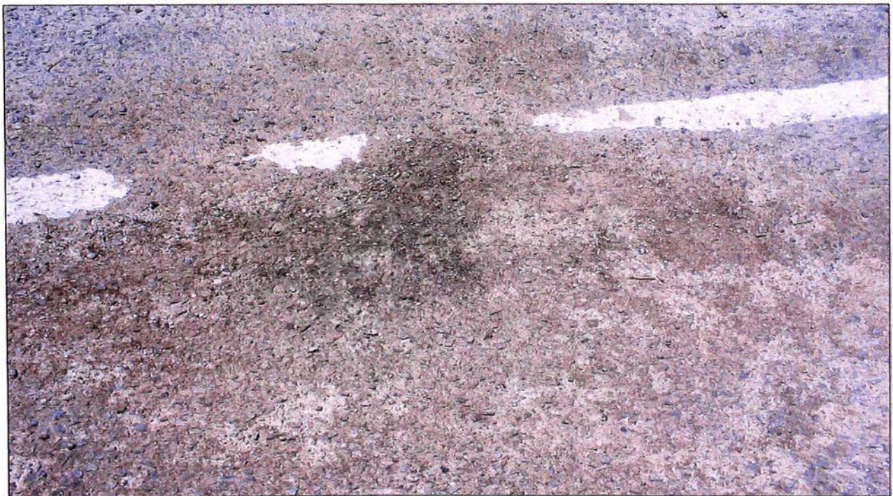
Fotografía N ° 06 Desgaste a 50 cm. del costado de vía
