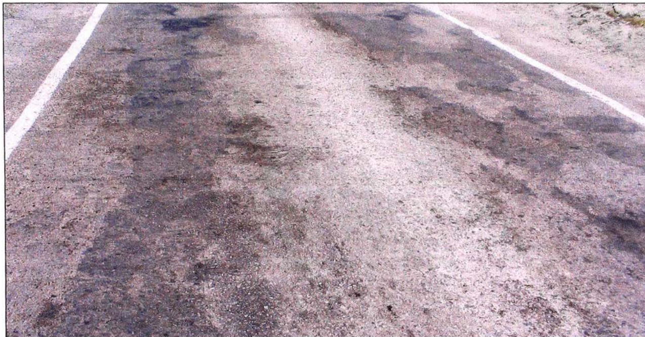
FIGURA N° 1.06: Fotografía Desgaste y parche de la vía
