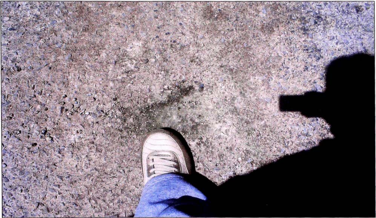
Fotografía N ° 05 Deterioro de la superficie
