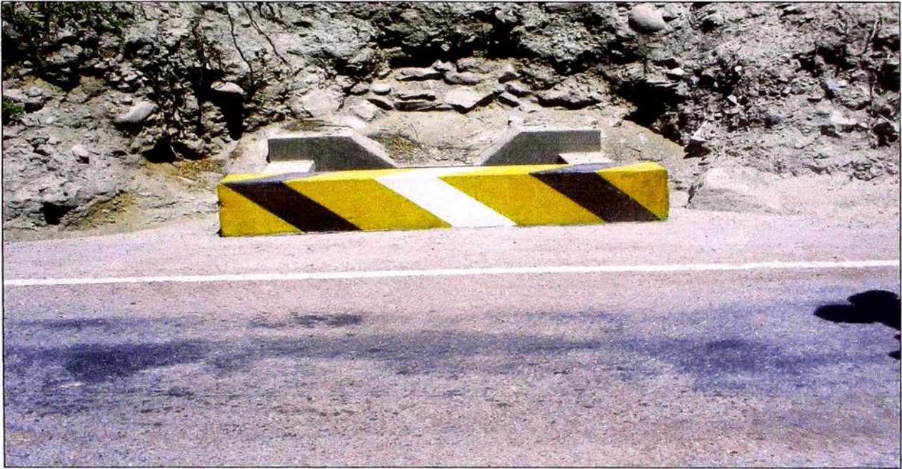
FIGURA Nº 1.04: Fotografía Alcantarilla sin cuneta de concreto
