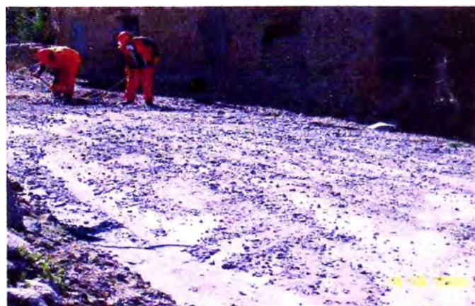
Fotografía 5.5 Limpieza de huayco menor, km 78+300 Fuente: Supervisión Proyecto Perú, panel fotográfico agosto de 2009
