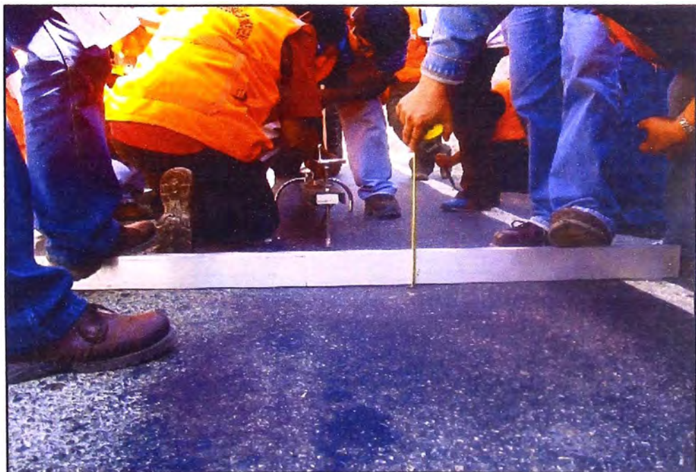
Foto 6: Medición del ahuellamiento en el punto de ensayo, con wincha y una regla de aluminio de 3m de longitud.
