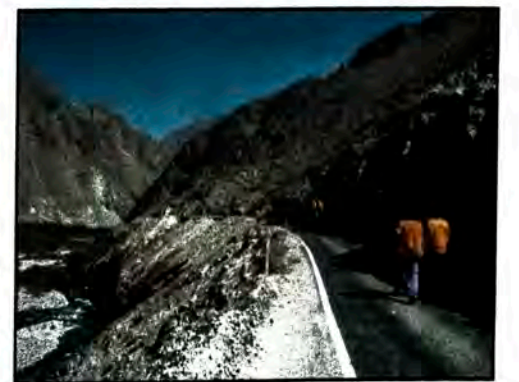
P2: Problema de erosión del río Cañete a la vía, se observa en la foto, ancho estrecho de la vía, presentado elevadas deflexiones.
