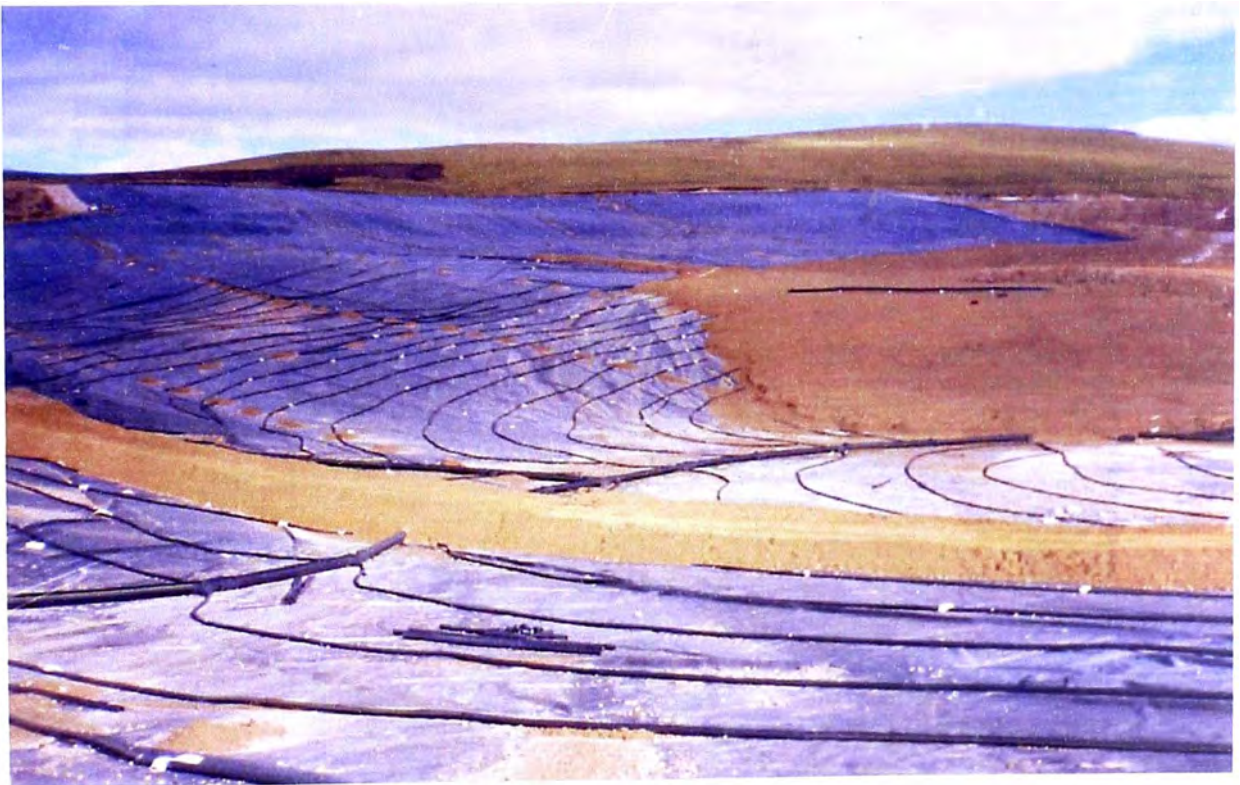
Figura 3.1.9-1.- Tuberías colectoras colocadas sobre el pad de Maqui Maqui
