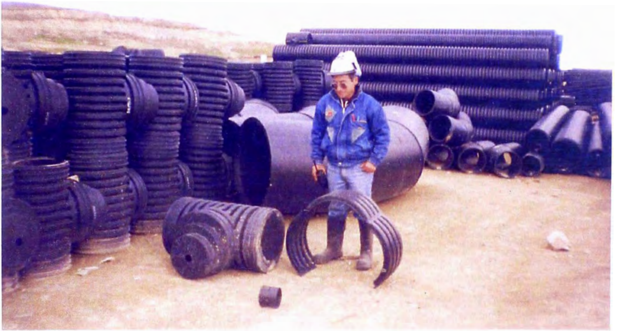
Tubería y accesorios de tuberías colectoras de solución
