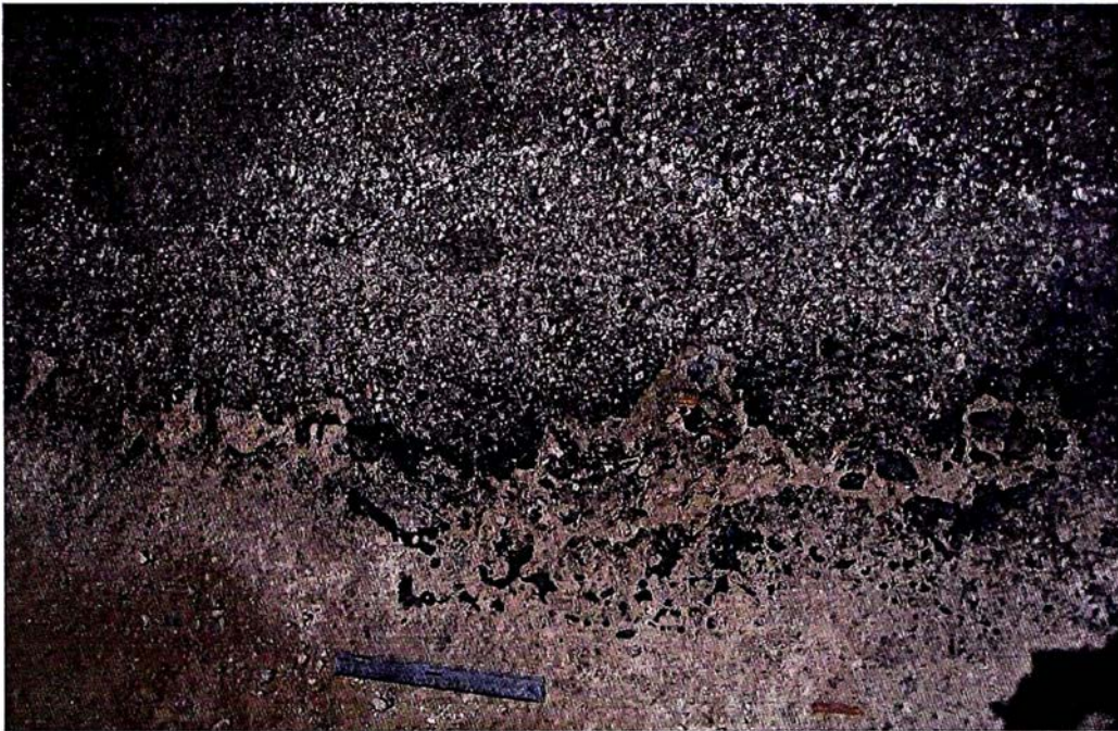
Km 87+050 Peladura en borde de pavimento
