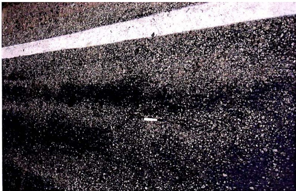
Km 87+180 Tramo con Exudación Moderada
