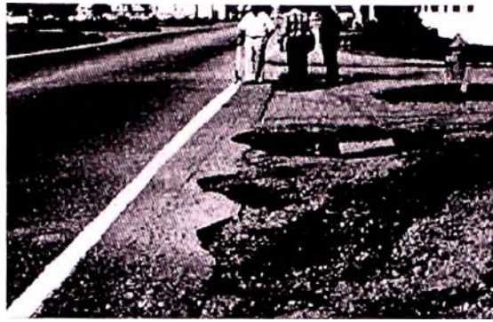
Fig. N°21 Grieta de borde severidad alta
