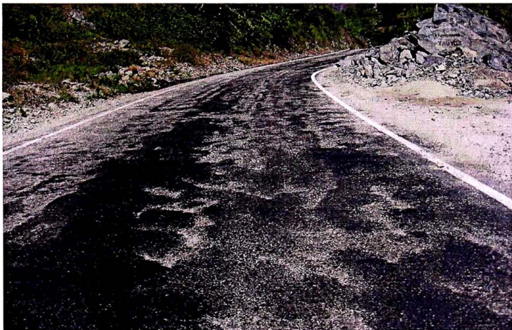
Km 85+300 Tramo con Exudación y Corrugación
