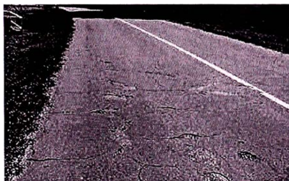
Fig. N°43 Disgregación y desintegración severidad alta
