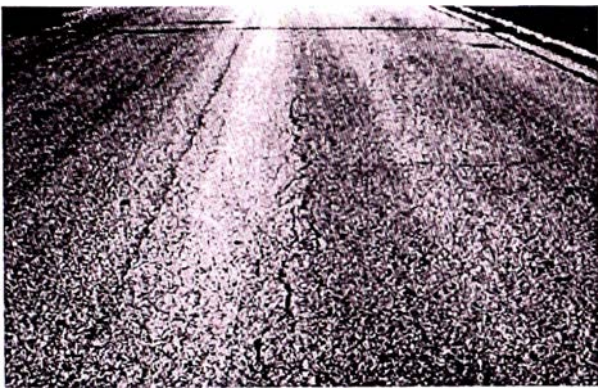
Fig. N°1 piel de cocodrilo severidad baja
