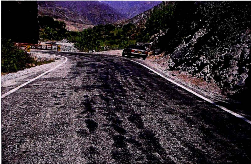
Km 85+410 Tramo con Exudación leve
