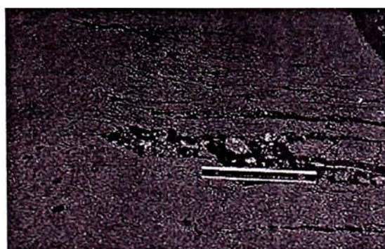
Fig. N°40 Grietas de deslizamientos severidad alta
