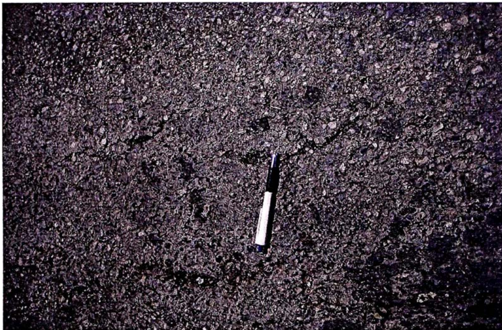
Km 88+900 Zona con fisura leve y puntual
