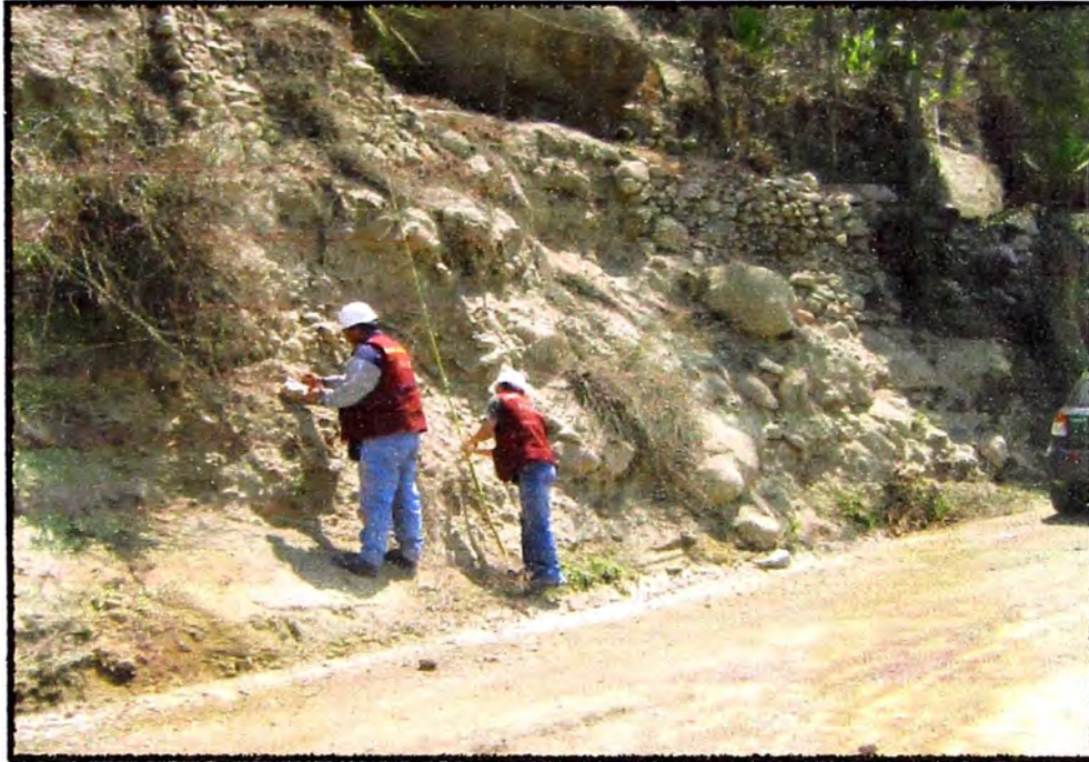
FOTO 3: Se observa el tramo de la carretera ubicado sobre la formación cuaternario reciente, compuestas por materiales sueltos o poco consolidados de naturaleza heterogénea y heterométrica, conformados por bloques, cantos y gravas sub-redondeadas, envueltos por una matriz areno-limosa, que se depositaron durante el Holoceno.
