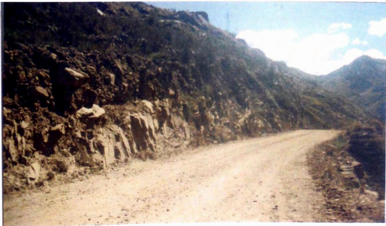
FOTO 8: La mina hace un mantenimiento constante del tramo de vía que utilizan.
