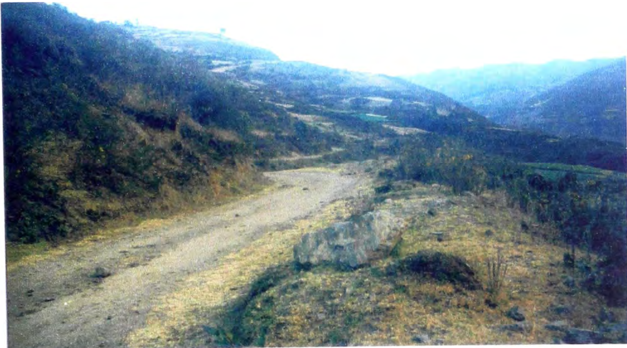
FOTO 9: Los tramos fuera de la influencia de la mina carecen de mantenimiento.
