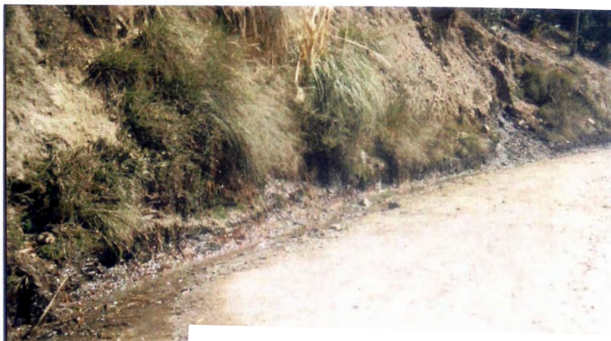
FOTO 14: Se observa las deficiencias que a la fecha de estudio las cunetas eran rústicas y faltas de mantenimiento.
