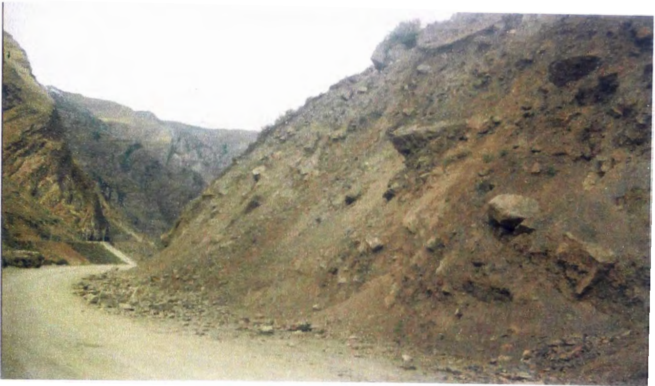
FOTO 11: Se aprecia el desprendimiento de materiales en los taludes de corte.
