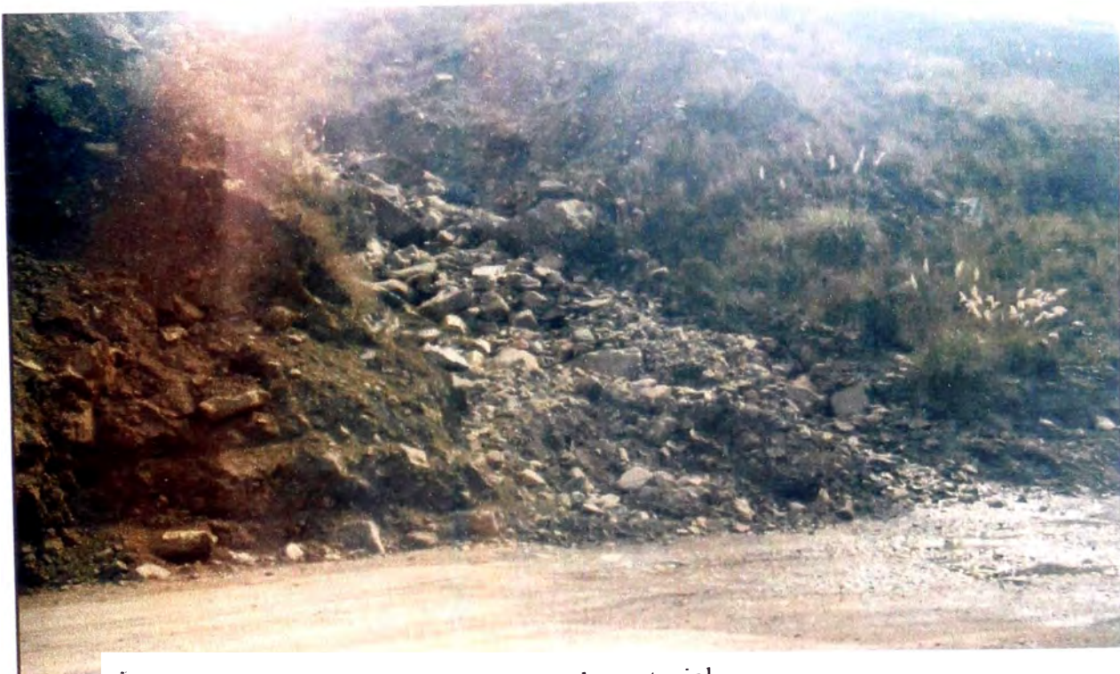
FOTO 10: En la foto se aprecia el arrastre de material.
