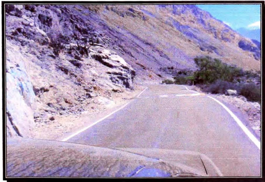
Presencia de Gibas en partes de las Vías
