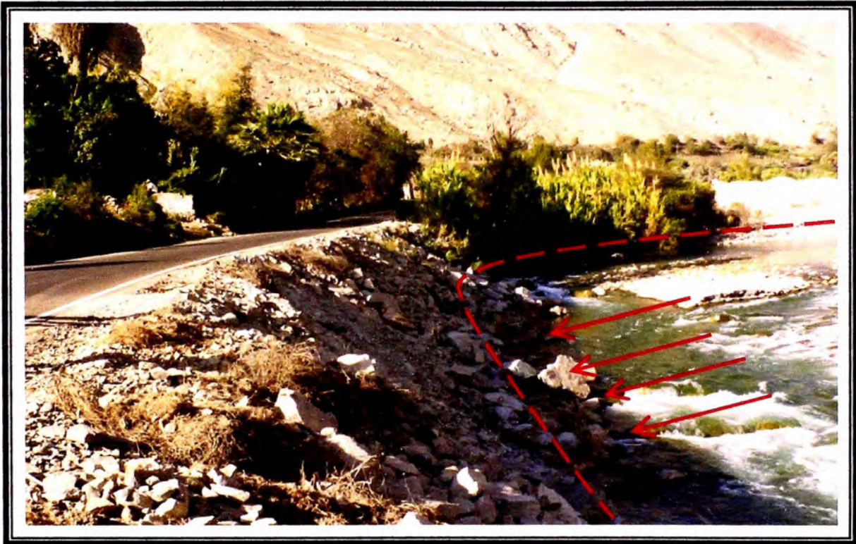
Foto Nro. 3.01 Se observa que el río Cañete erosiona el talud inferior de la carretera en tramo curvo.
