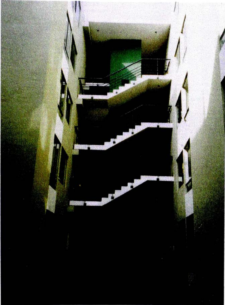
Foto 18: Vista del lado derecho del patio interior y escalera N° 2 que comunican los departamentos del block delantero y posterior.
