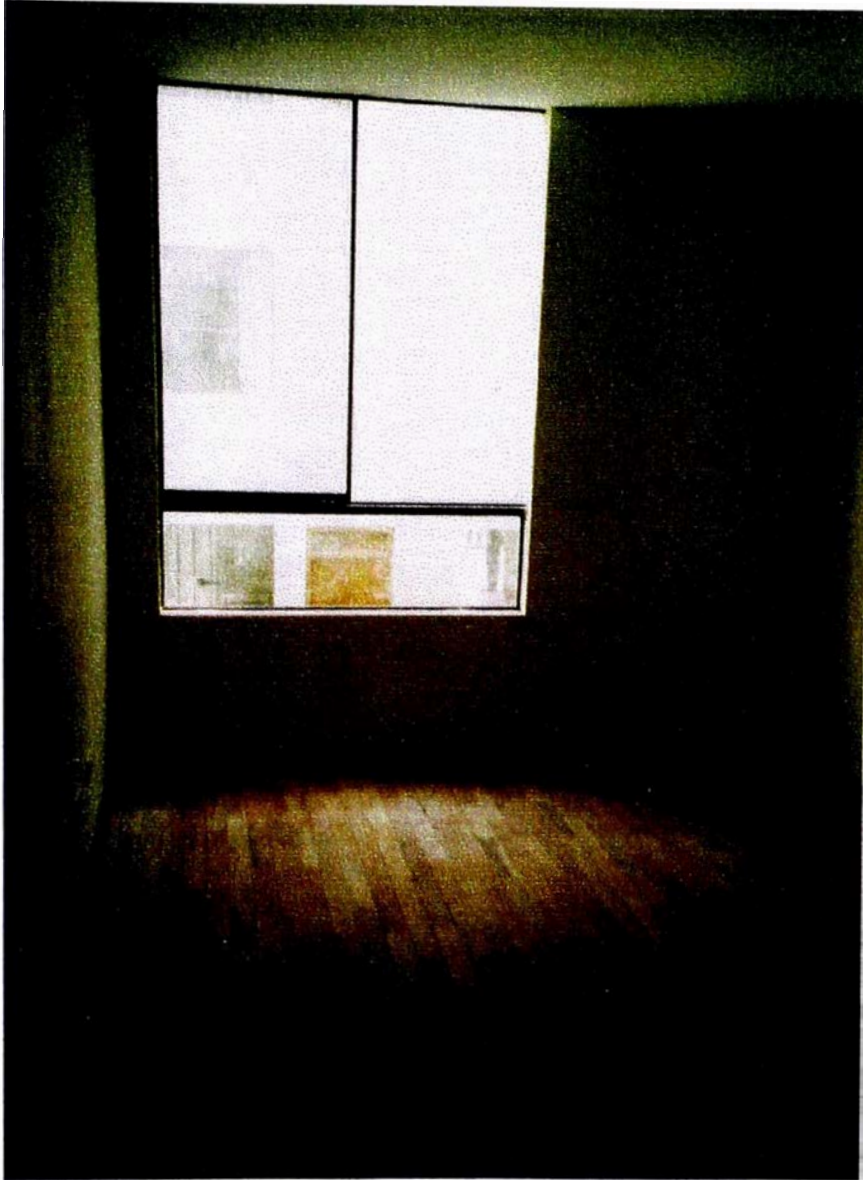
Foto 15: Ventana de aluminio del sistema Nova, contrazócalos de madera cedro y piso de parquet en dormitorio
