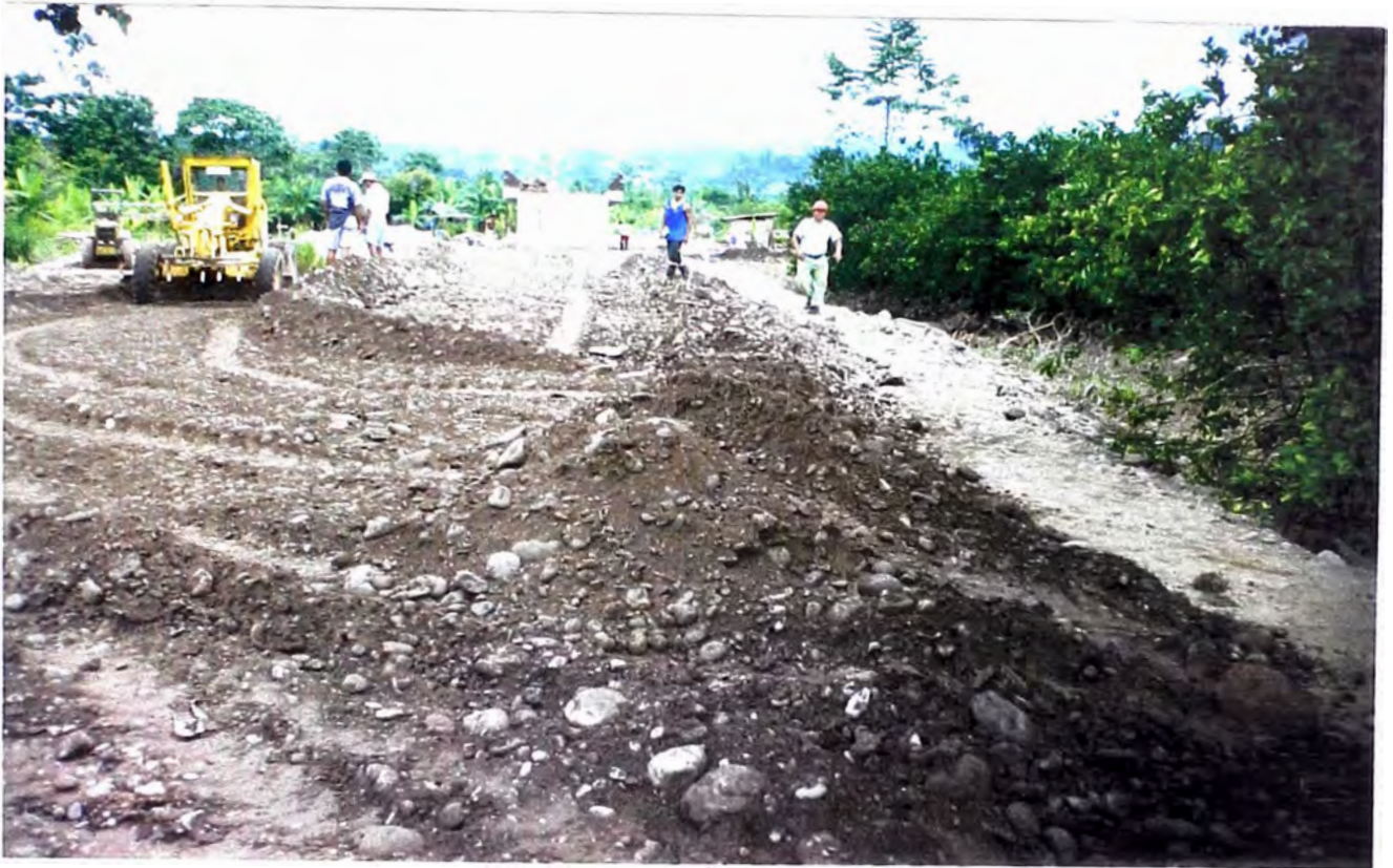
FOTO N° 45: Se observa el trabajo de la motoniveladora en el acceso del puente.
