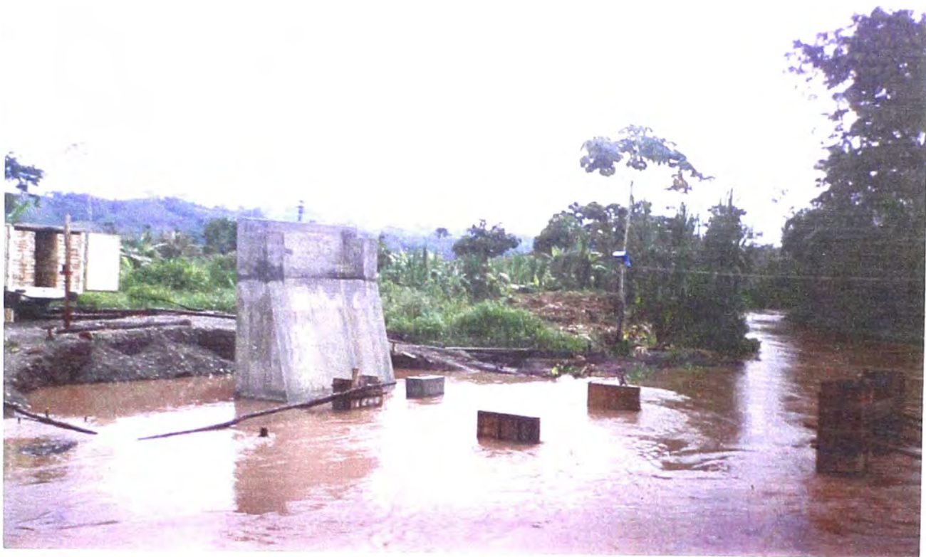
FOTO N° 17: En la vista se observa la crecida del rio Pacae.
