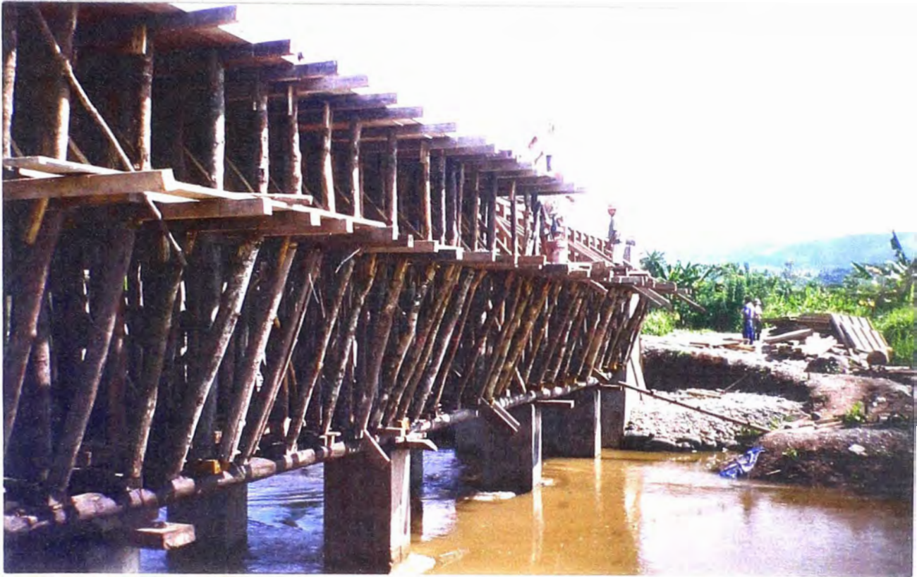
FOTO N° 21: Se observa el encofrado de la viga y la losa del puente.
