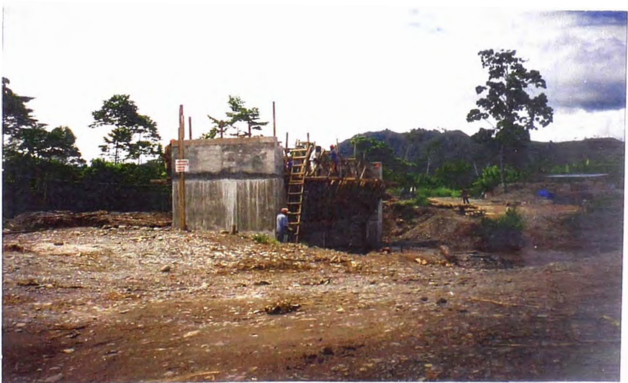
FOTO N° 20: Se observa la construcción del falso puente para el encofrado de la super estructura.
