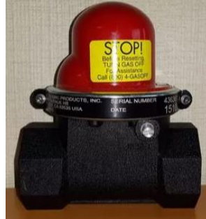
Figura 5. Válvula de cierre rápido para corte del flujo de gas en caso de sismo
