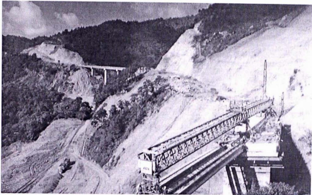
Fig. 1.2 Construcción Puente La Galera; Superestructura Continua de Vigas Postensadas Pre-Fabricadas; Veracruz, México
