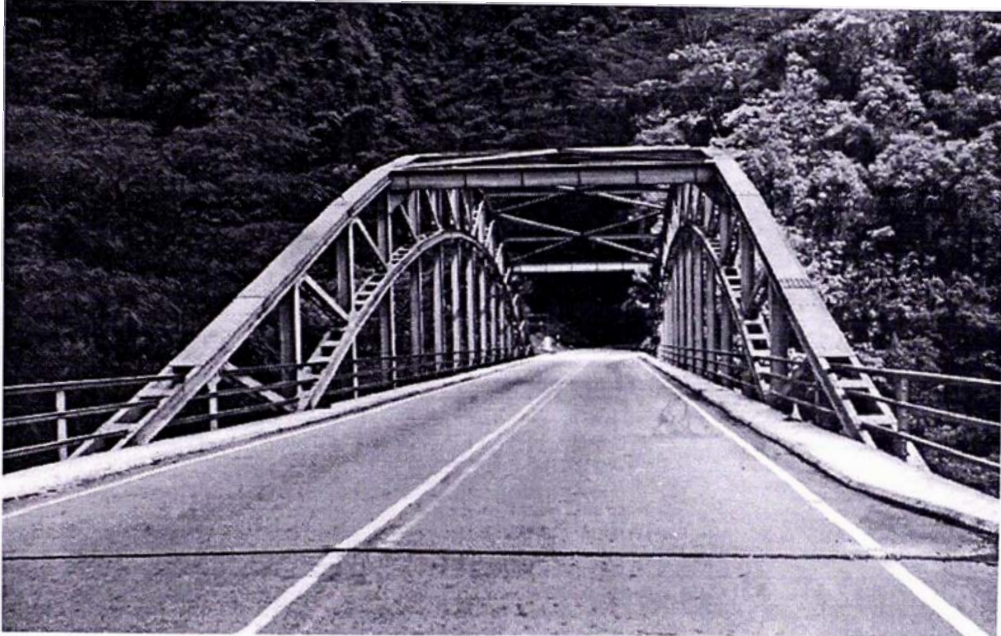
Fig. 1.4 Puente San Félix, Reticulado en Arco; ubicado en la Carretera Tarma – La Merced
