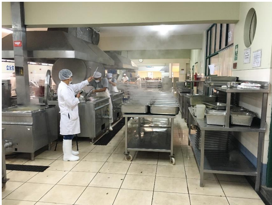
Foto 7. Medición de la velocidad de aire
