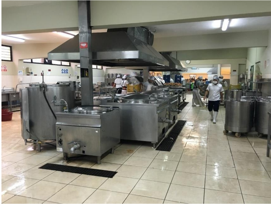
Foto 12. Vista de perfil de las campanas extractoras
