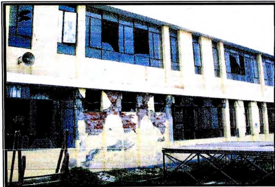
Figura N° 04: Ejemplo de falla típica por columna corta.
