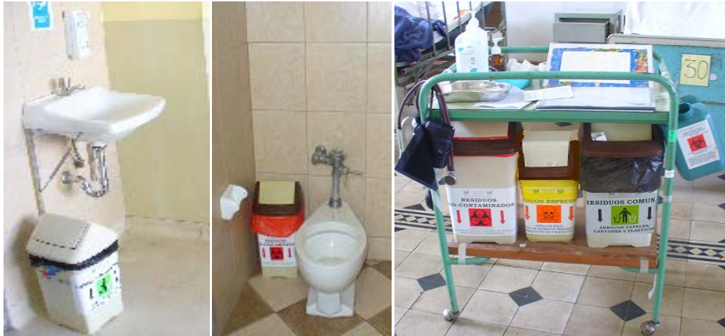
Fotos 1, 2 y 3. Acondicionamiento de ambientes y equipo con insumos y materiales para la disposición de residuos sólidos
