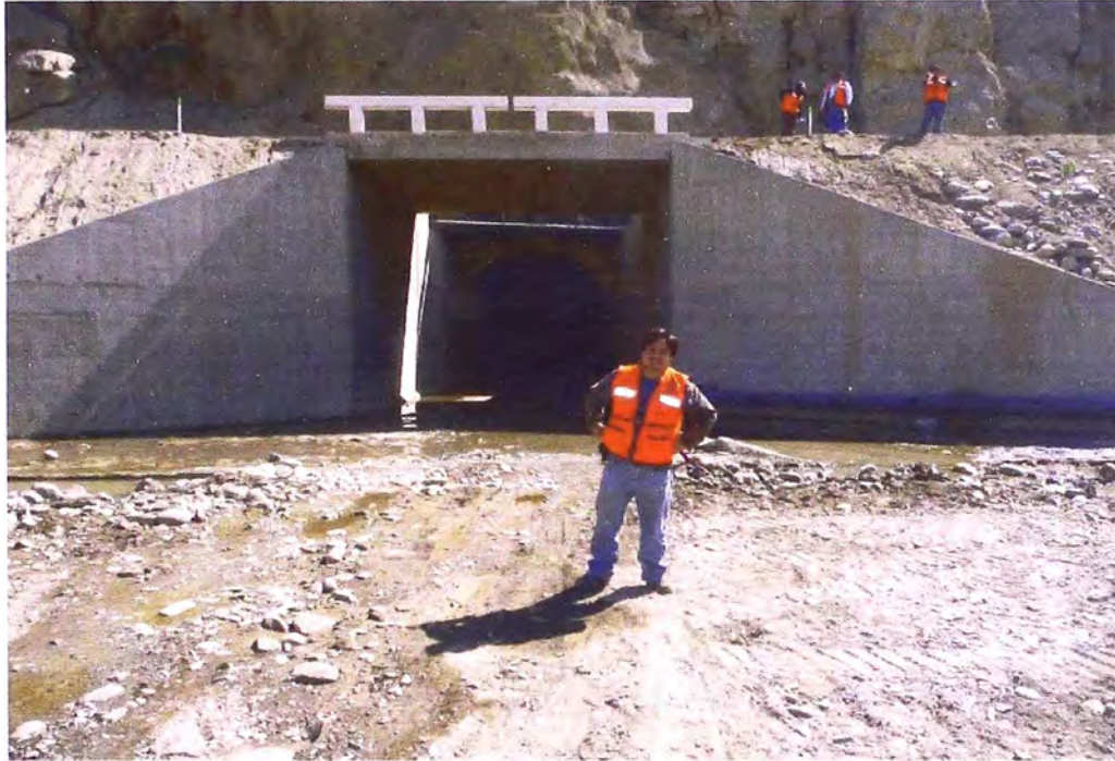
Foto N° 23: Km 65+320 Salida principal del túnel de aducción de 12.5 Km de largo de la Central Hidroeléctrica El Platanal. Este puente es de luz de 7.50 m y ancho de 4.00 m, de concreto armado. Es el único puente ubicado entre los 05 Km en estudio que se encuentra en buenas condiciones.
