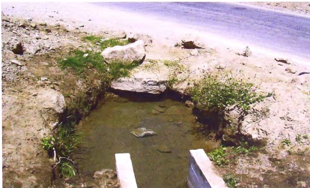
Foto N° 12: Km 67+000: Aguas arriba canal de riego. Necesidad de diseño de emboquillado.
