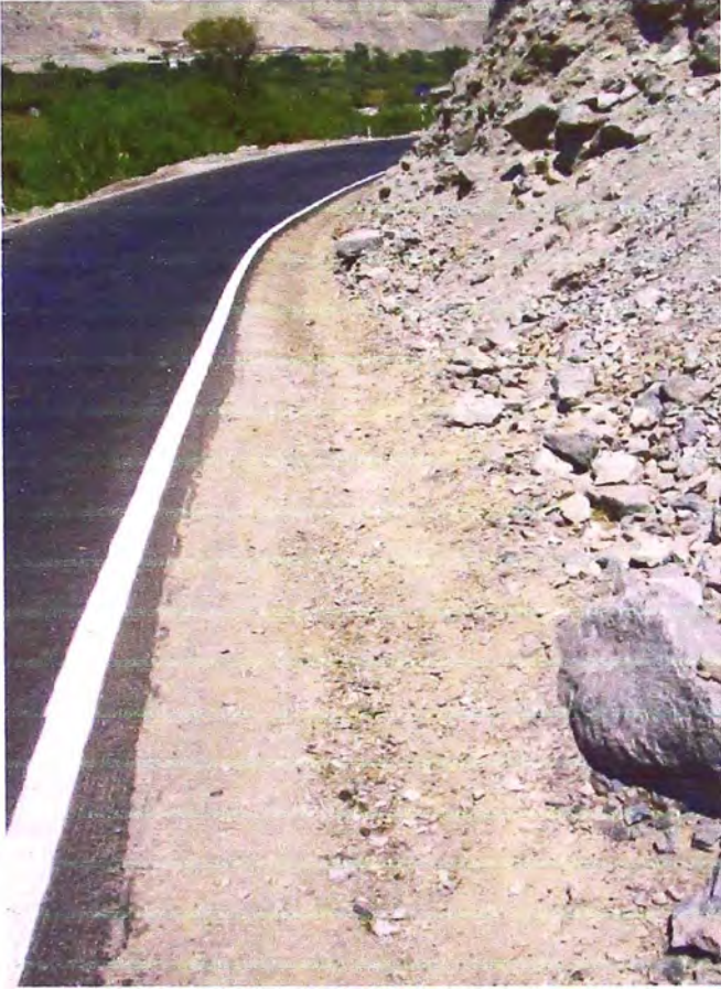
Foto N° 3: Km 68+800 al Km 68+860: Cunetas de tierra en mal estado
