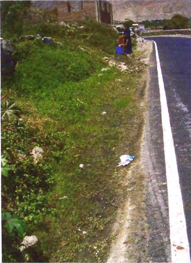
Foto N° 17: Km 67+000 al Km 67+400 Necesidad de tajeas de tubería de PVC D=6", para derrame agua de terrenos de cultivo.
