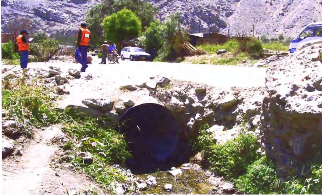
Foto N° 21: Km 65+620 es necesario la construcción de un emboquillado, a ambos lados de la alcantarilla de TMC de D=48".
