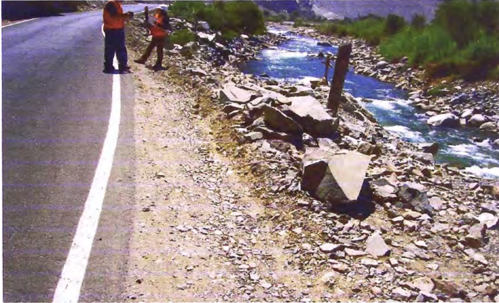
Foto N° 5: Km 68+640, Cunetas de tierra innecesarias, lo que se debió hacer es hacer una plataforma con adecuada pendiente que dé al Rio Cañete.
