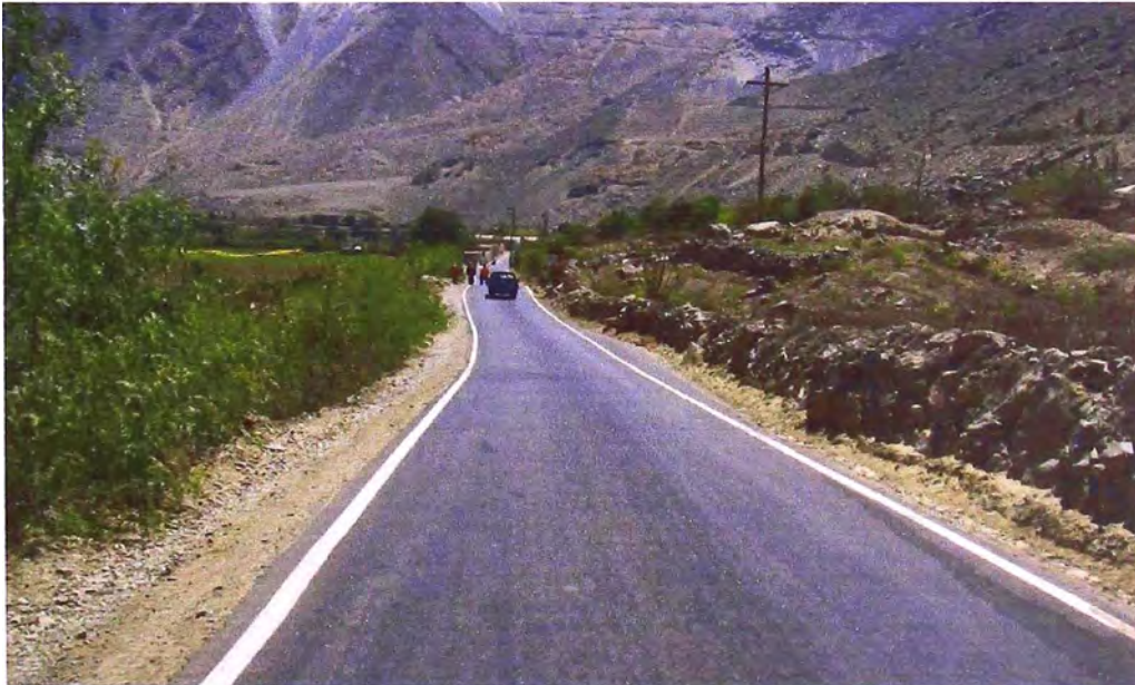
Foto N° 14: Km 65+000 al Km 68+000, Cunetas en mal estado.
