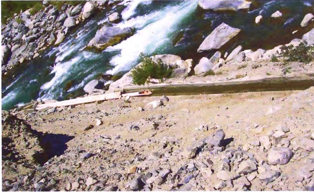
Foto N° 9: Km 68+200: Canal de riego y empalme con tubería de PVC, este canal esta afectado por los deslizamientos de bolonería que provienen de la parte superior de la carretera.
