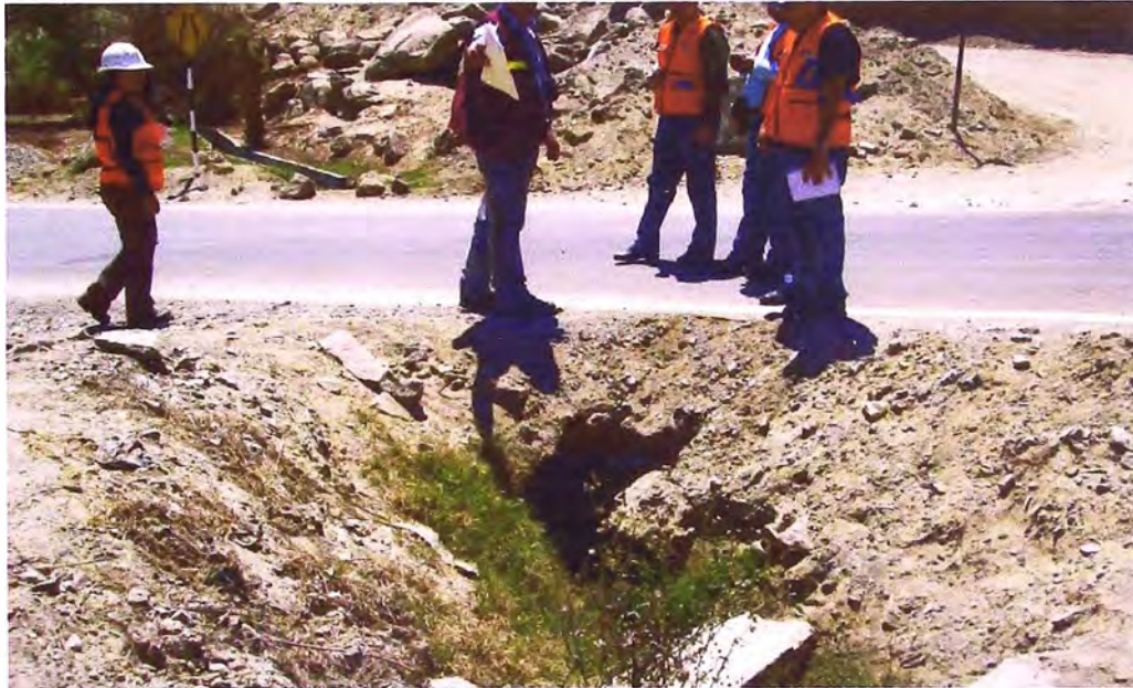
Foto N° 11: Km 67+000: Canal de riego atraviesa la vía mediante una alcantarilla rustica, lo cual hace necesario la construcción de una nueva alcantarilla, con nuevos emboquillados a cada extremo de esta.
