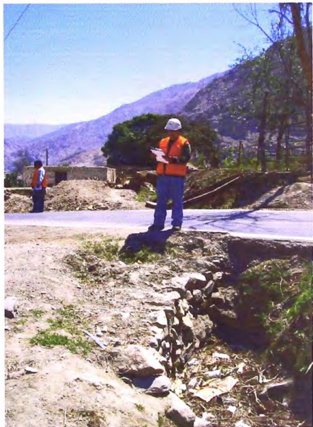
Foto N° 19: Km 67+620 es necesario la construcción de un emboquillado, además de 01 alcantarilla de TMC de D=46”.
