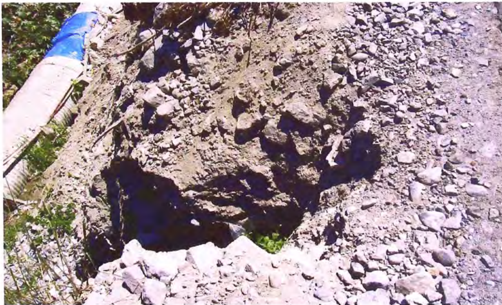
Foto N° 20: Km 66+200 necesidad de tajea de tubería de PVC D=6”, para derrame agua de terrenos de cultivo.
