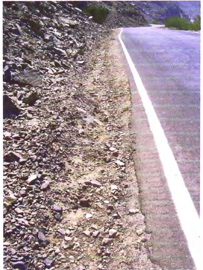
Foto N° 4: Km 68+700 al Km 68+740, Cunetas de tierra en mal estado
