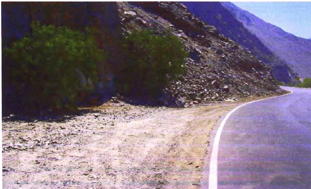
Foto N° 6: Km 68+600: Cunetas inexistentes, pero necesarias debido a las precipitaciones que se presentan en las estaciones lluviosas del año, que dañarían la base estabilizada.
