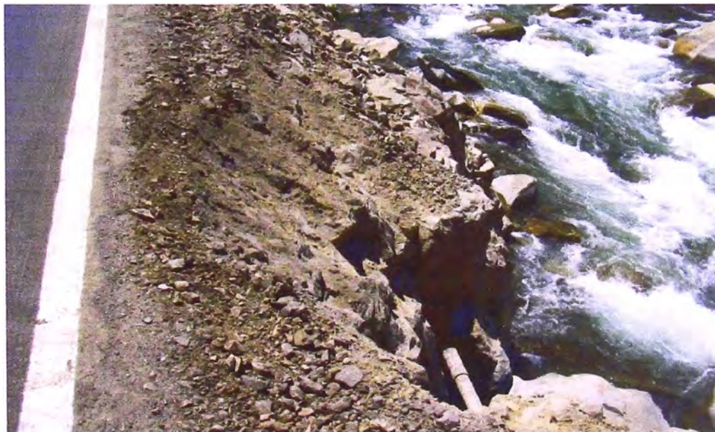
Foto N° 8: Km 68+420: Necesidad de defensa ribereña, se propone un enrocado D50.
