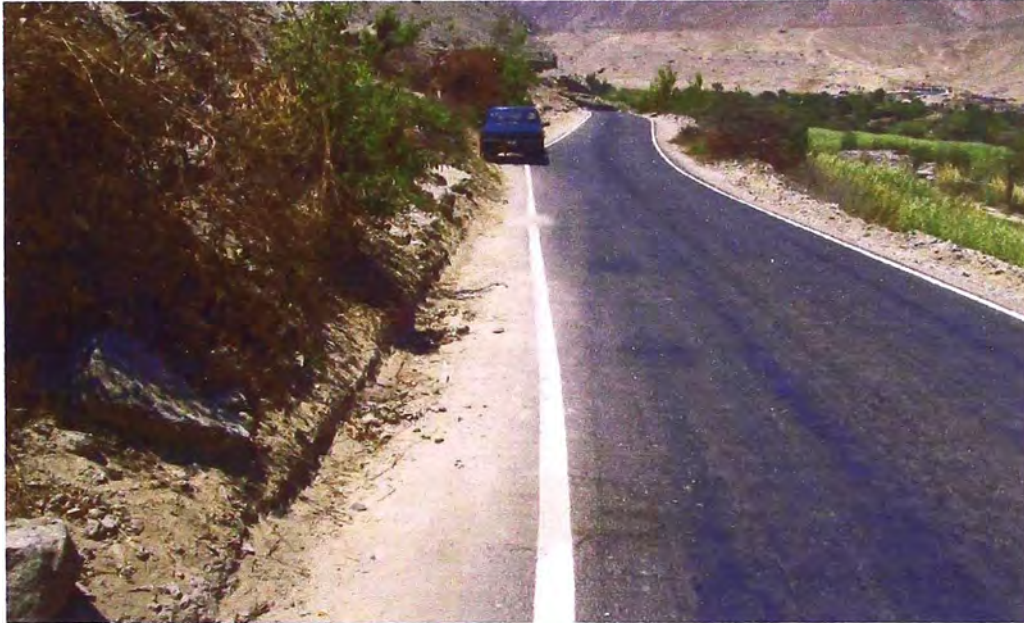
Foto N° 13: Km 65+600 al 66+400: Necesidad 03 alcantarillas o tajeas, tubería de PVC de D=4", de longitud 5.00 m c/u, por derrame de agua de terrenos de cultivo adyacente a la carretera.
