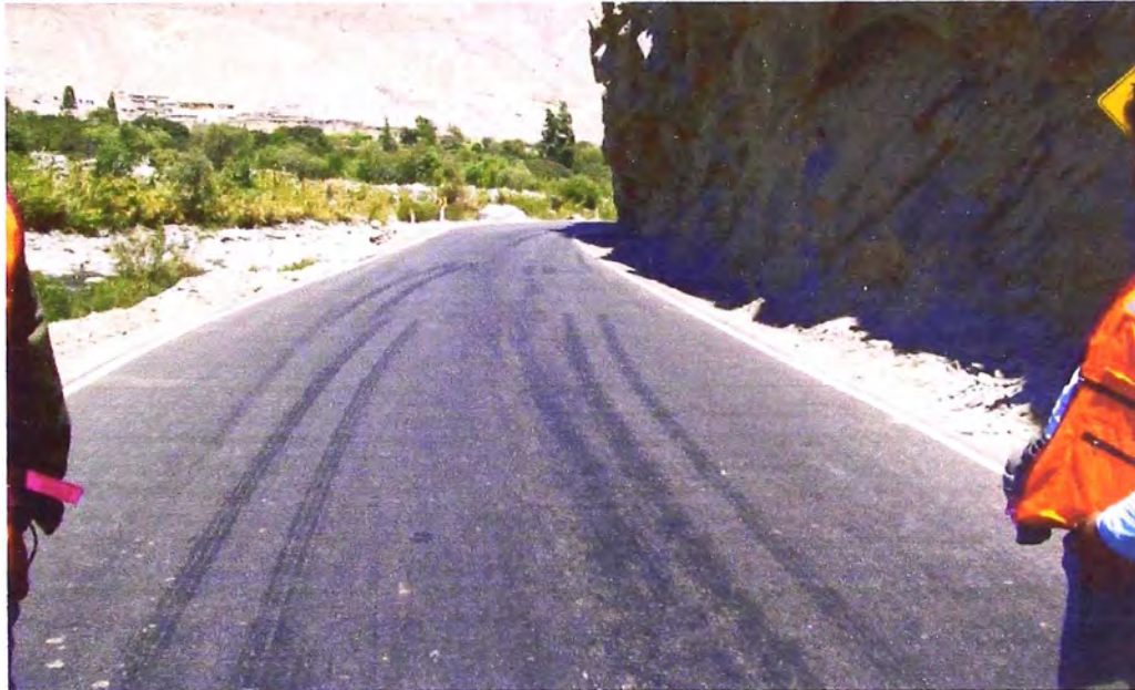
Foto N° 7: Km 68+440: Peligro de accidente, por zona rocosa y taludes altos. Necesidad de hacer voladura de rocas para ensanchar la vía, ya que es constante lugar de accidentes de tránsito.
