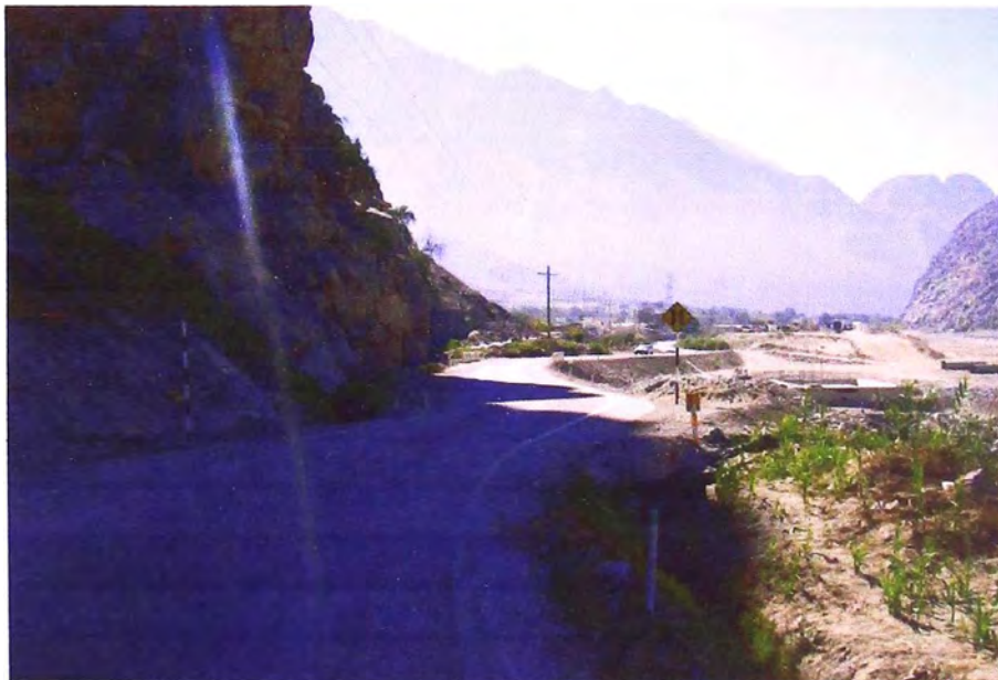
Foto N° 24: Km 65+060, Alcantarillas para cruce de canal de regadío, donde se propone cambiar la alcantarilla rustica por una de TCM de D=48"
