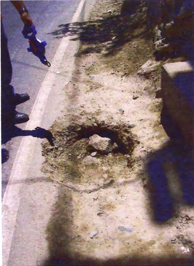
Foto N° 15: Km 67+590 Necesidad de alcantarillas, para evitar filtraciones y derrame de agua por los terrenos de cultivo adyacentes.
