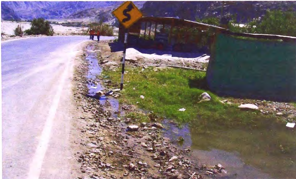
Foto N° 22: Km 65+900 empozamiento de agua debido a la planta de tratamiento de agua, debido al campamento ubicado adyacente a la vía
