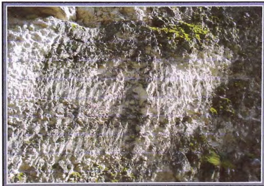
Pared de talud formado de caliza erosionada.
