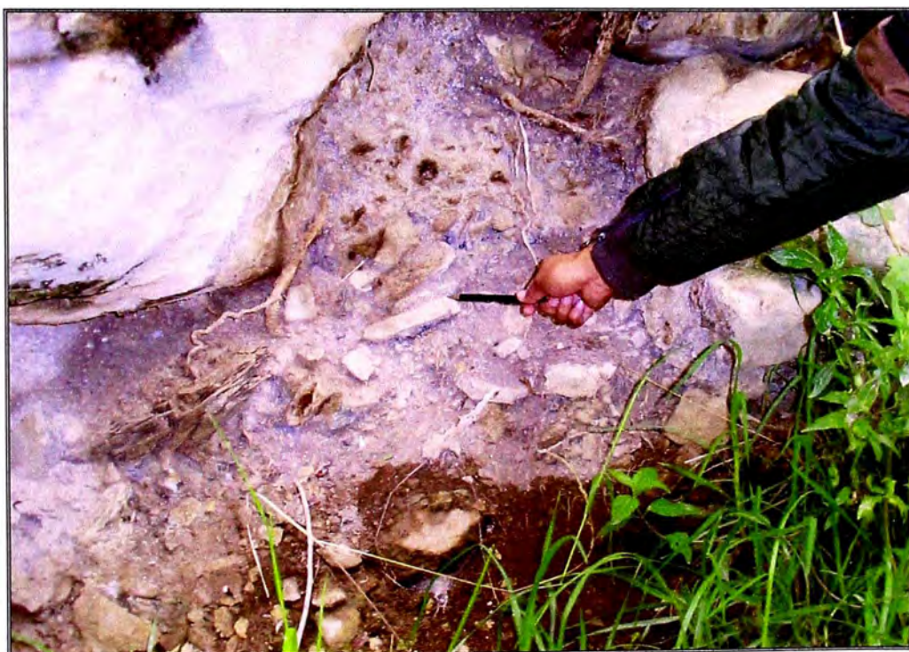
Foto N° 4 Depósito coluvial que colinda con la margen izquierda de la carretera, Km 166+380 al Km 166+500, Alis (foto J. Centeno).
