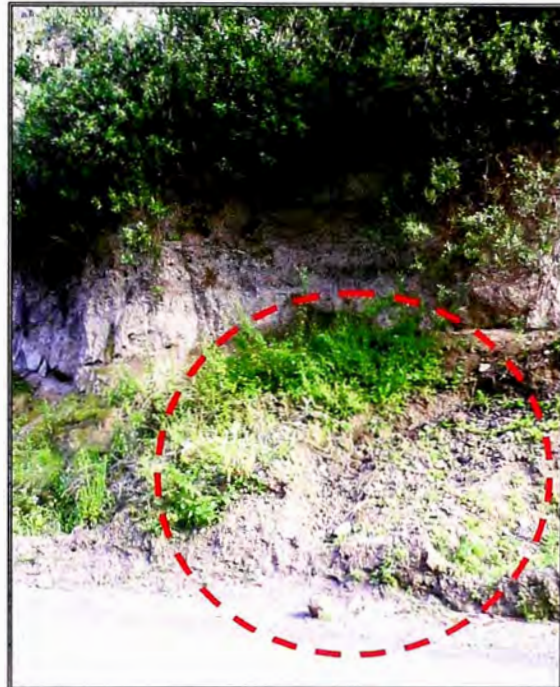
FIGURA N° 2.2.7.2 MOVIMIENTO DEL TALUD
