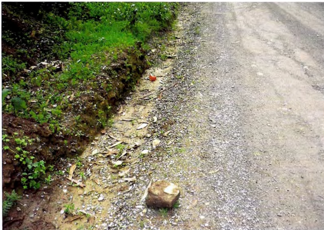
Foto 7. En la foto se observa que se formo una zanja de tierra a un costado de la carretera, producto de las lluvias que caen en el talud izquierdo
