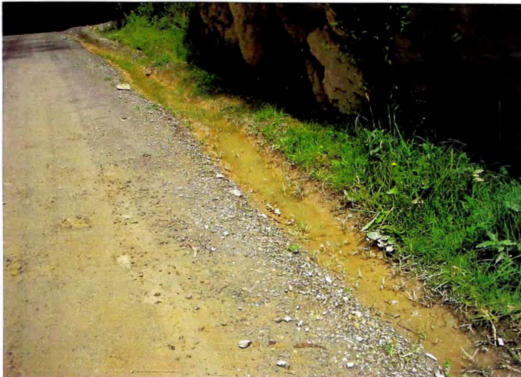
Foto 6. En la foto se observa la acumulación de agua en el pie del talud, debido a la de un sistema de drenaje longitudinal.
