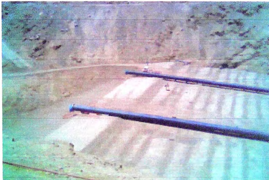
Fig. N 27 Tendido de tubería de HDPE de 42" en Represa de PLS
