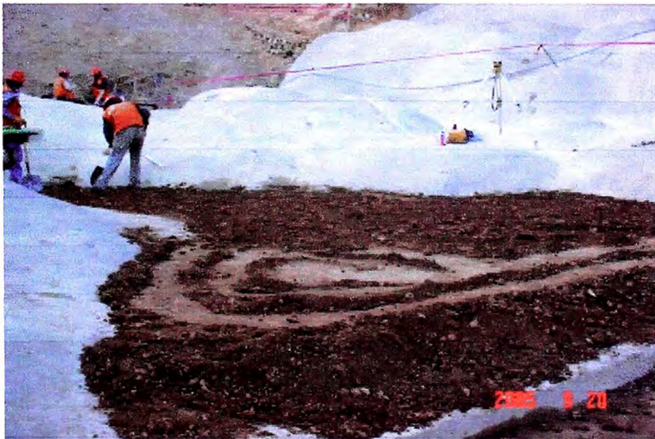
Fig. N 23 Relleno con equipo menor en el fondo de las represas
