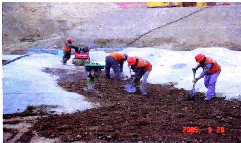
Fig. N 36 : Zona totalmente irregular que dificultaron los rellenos en el cuerpo de la presa
